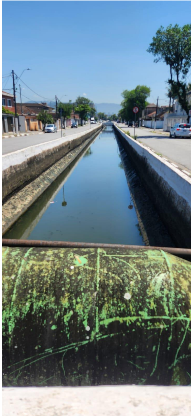
Figura 11 - Imagem do canal da Rua Alberto de Carvalho, a partir da Av. Jovino de Mello
