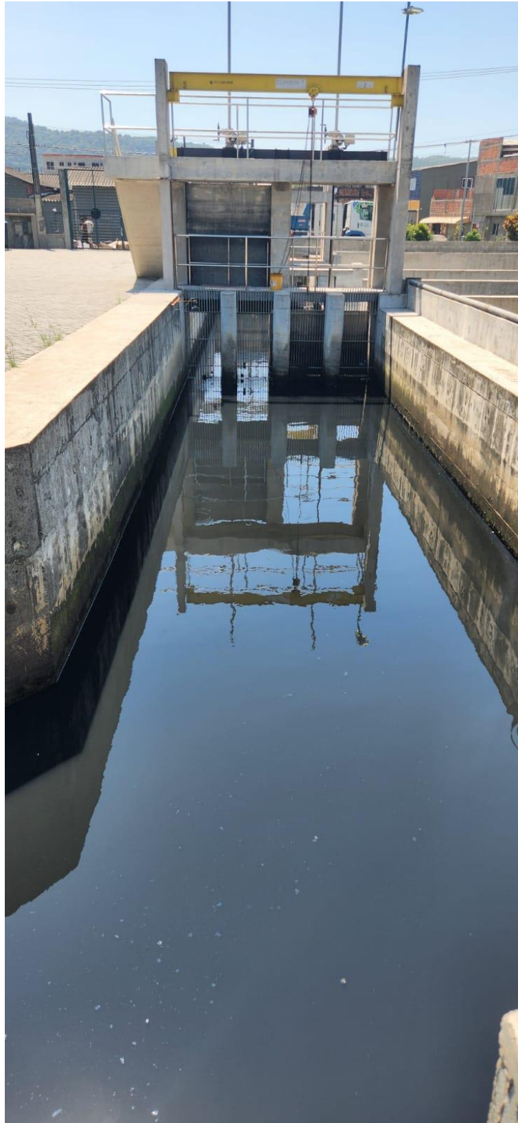
Figura 21 - Imagem da comporta da estação elevatória - Rio dos Bugres
