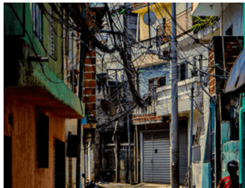
2. SEM ENERGIA ELÉTRICA
