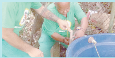
Instalação de uma caixa d'água na base da Polícia Militar no Cruzeiro - Morro São Bento
