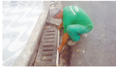
Reparo em grelha de boca de lobo na Av. Pedro Lessa - Embaré
