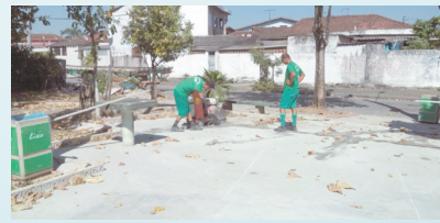
Abertura das juntas de dilatação na Praça dos Ex-Combatentes - Rádio Clube
