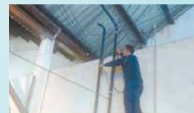
Instalação de refletores na Cotran - Vila Mathias
