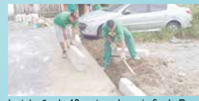
Instalação de 13 metros de meio fio da Rua Santa Elizabeth - Morro São Bento
