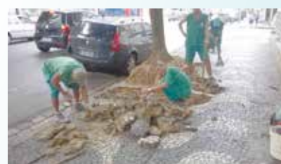
Reparo em calçada danificada por raízes de árvores na Rua Saturnino de Brito - Marapé
