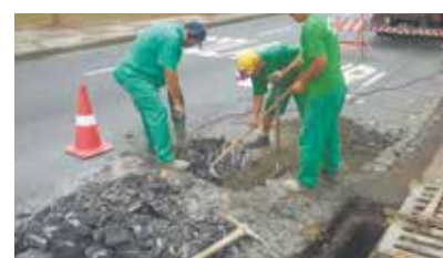
Reparo em abatimento na Av. Bartolomeu de Gusmão, sentido Ponta da Praia - Embaré
