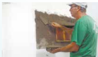
Fechamento de ar condicionado - Codeso - Vila Nova
