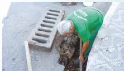
Reparo na boca de lobo na Rua Constituição com Rua Almeida de Moraes - Vila Mathias
