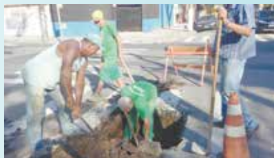
Reparo em abatimento na Rua Constituição com Rua Almeida de Moraes - Vila Mathias
