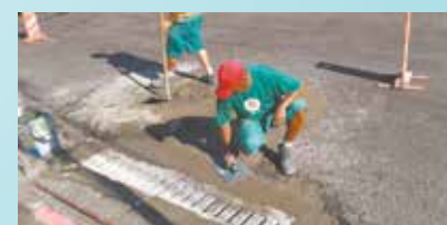
Troca de grelha na Av. Martins Fontes com Av. Nossa Senhora de Fátima - Chico de Paula
