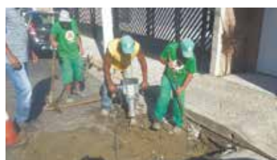
Abatimento da Rua Adolfo Lutz - Ponta da Praia
