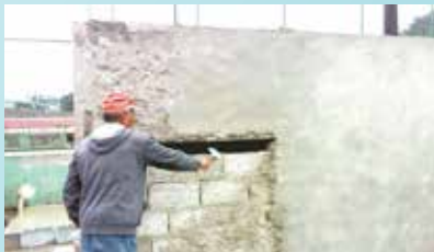
Reboco na arquibancada da Praça Guilherme Délius - Vila Haddad
