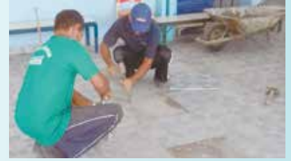
Reparo no piso cerâmico no pátio e na sala de aula - Monte Cabrão
