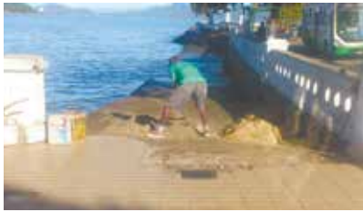
Reparo no piso e na rampa na Ponte Edgard Perdigão - Ponta da Praia
