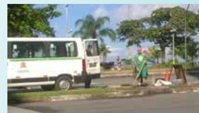
Reparo em boca de lobo na Av. Presidente Wilson, próximo ao canal 2 - José Menino
