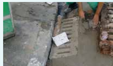
Substituição de grelhas de bocas de lobo na Avenida Senador Feijó - Vila Mathias
