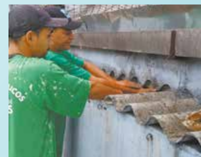
Troca de madeiramento e colocação de rufos na Creche Irmã Maria Dolores - Paquetá
