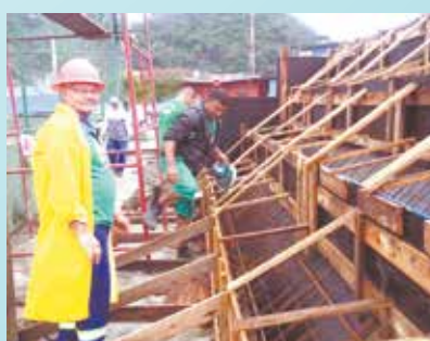
Fixação dos painéis para concretagem da arquibancada da Praça Guilherme Délius - Alemoa
