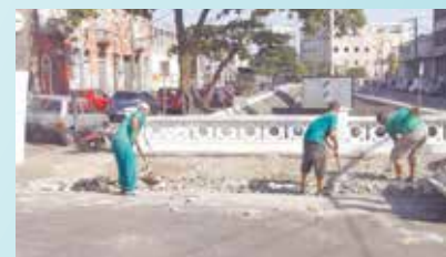
Reparação para nova calçada em concreto desempenado. Canal da Campos Sales - Vila Nova
