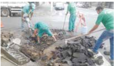
Abatimento na Rua Evaristo da Veiga - Campo Grande
