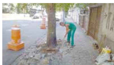
Rua Pernambuco - Reparo em calçada danificada por raízes de árvores - Gonzaga
