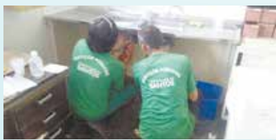
Fixação da pia da sala de emergência no Hospital Silvério Fontes - Castelo
