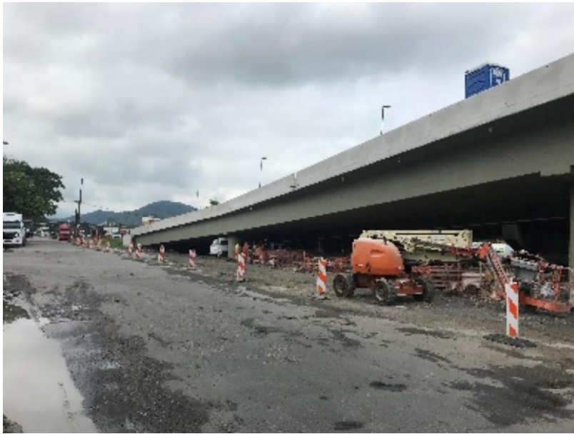
Foto 2.2.2-2: Rua Augusto Scaraboto - Desagregação do pavimento asfáltico / pontos com falha no sistema de drenagem pluvial.
