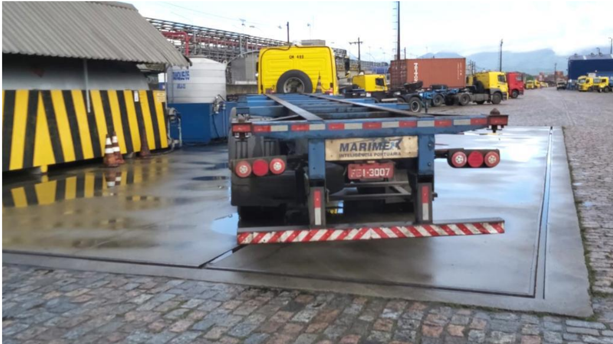
Figura 6 – Imagem extraída do EIV, em que mostra a área de abastecimento com canaletas direcionais para caixas separadoras
