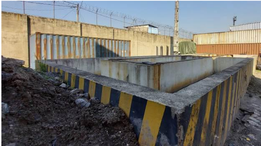
Figura 15 - Figura extraída do EIV: Dique de contenção para contêineres com avarias ETE-BIO01.
