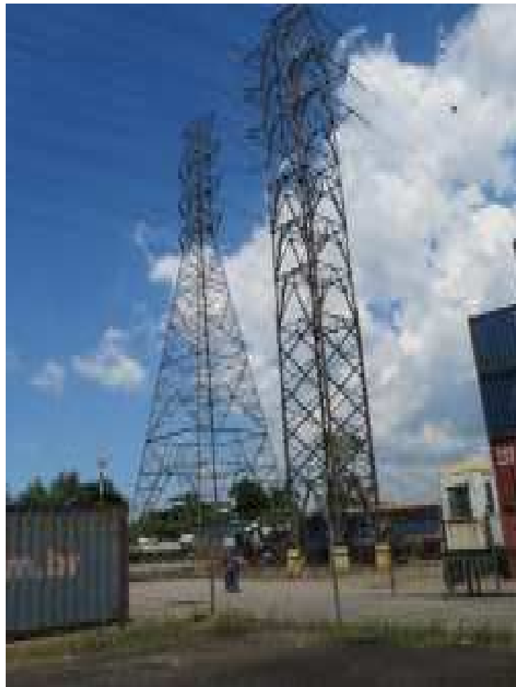
Figura 5 – Vista parcial das torres de cabos de energia
