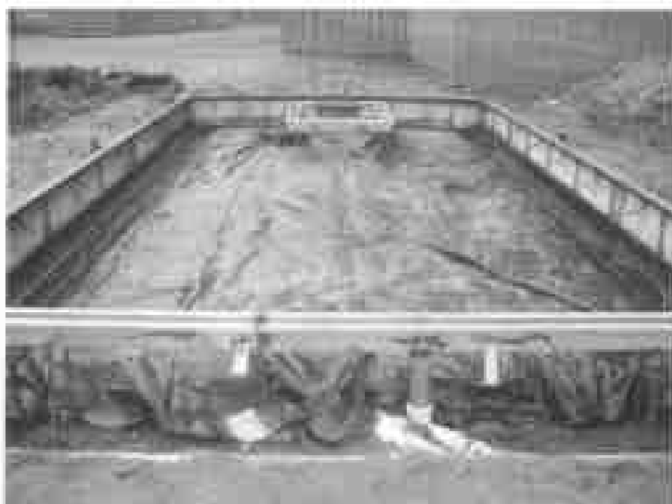
Foto 4. Colocação de lona e caixoteis para captação de efluentes do dreno da base de contenção do tanque.
