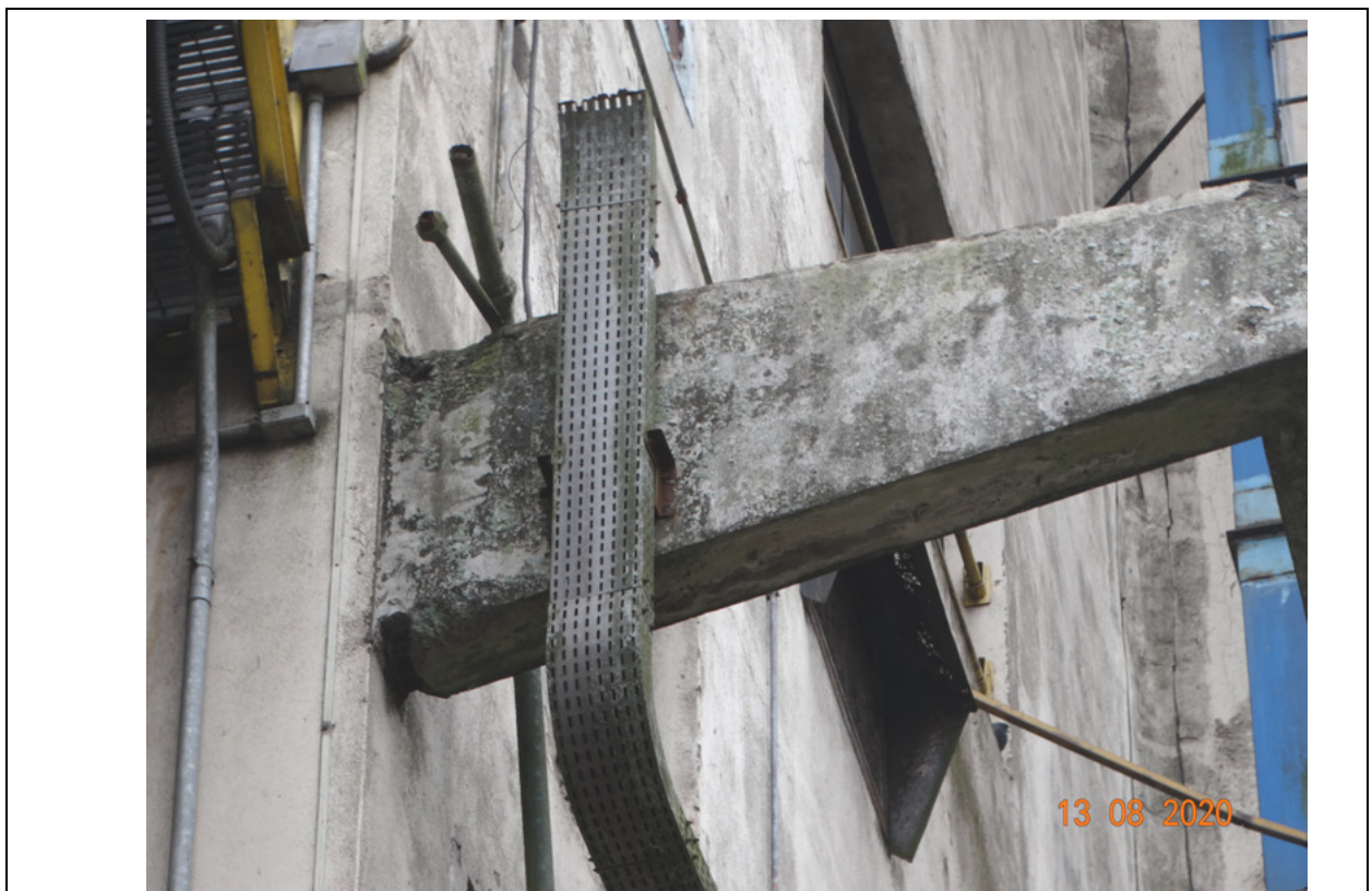
FOTO 08 – DETALHE DA FOTO ANTERIOR Nº 07. SUJIDADES SOBRE O CONCRETO.
