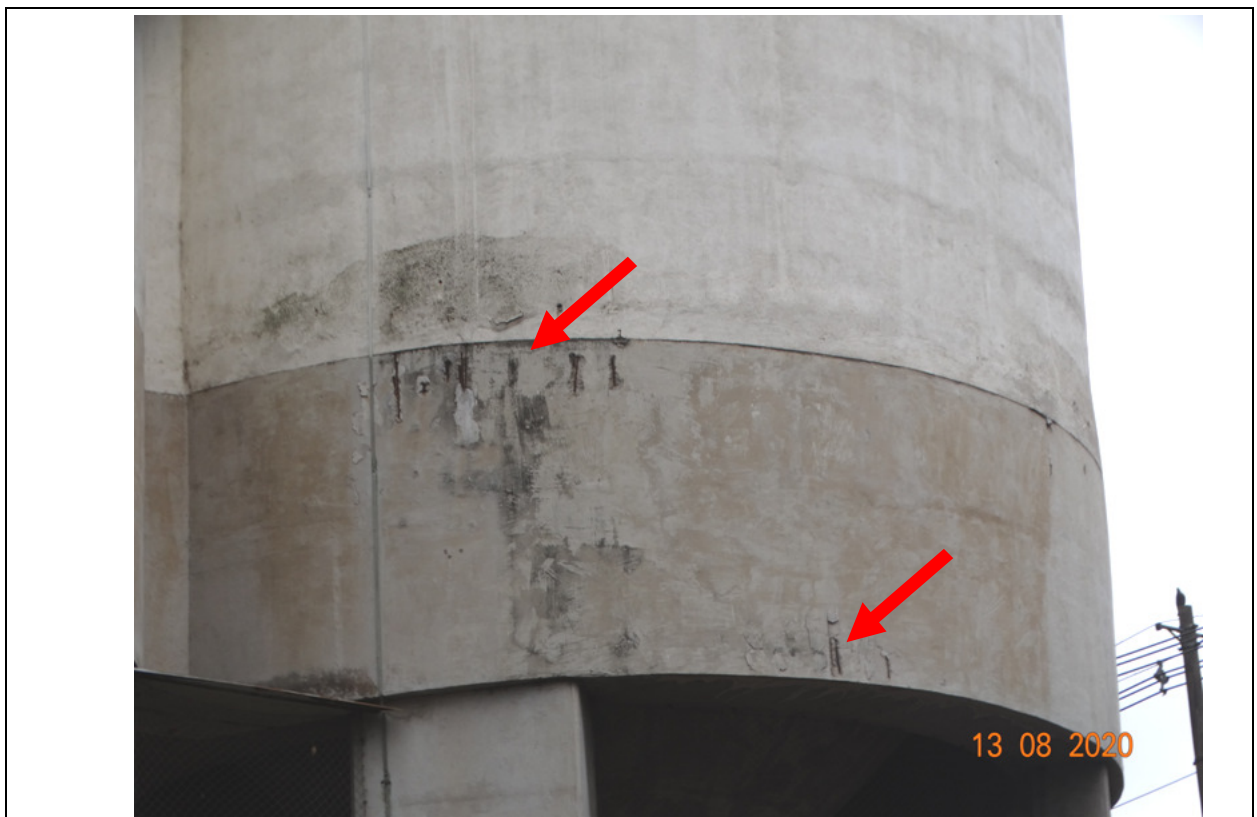
FOTO 34 – DETALHE DA FOTO ANTERIOR Nº 33. INDÍCIOS DE CORROSÃO DE ARMADURA.
