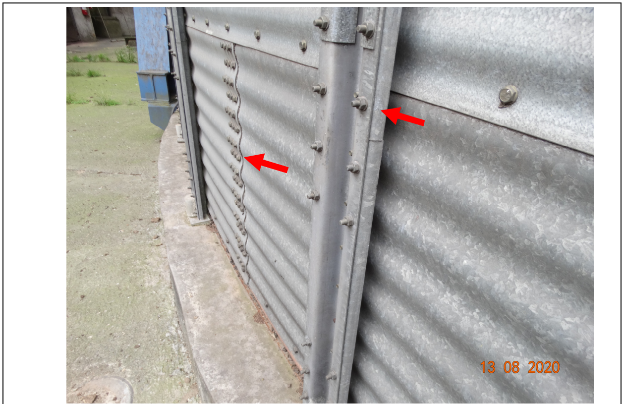
FOTO 12 – DETALHE DE FIXAÇÃO DAS PEÇAS DOS SILOS METÁLICOS.
