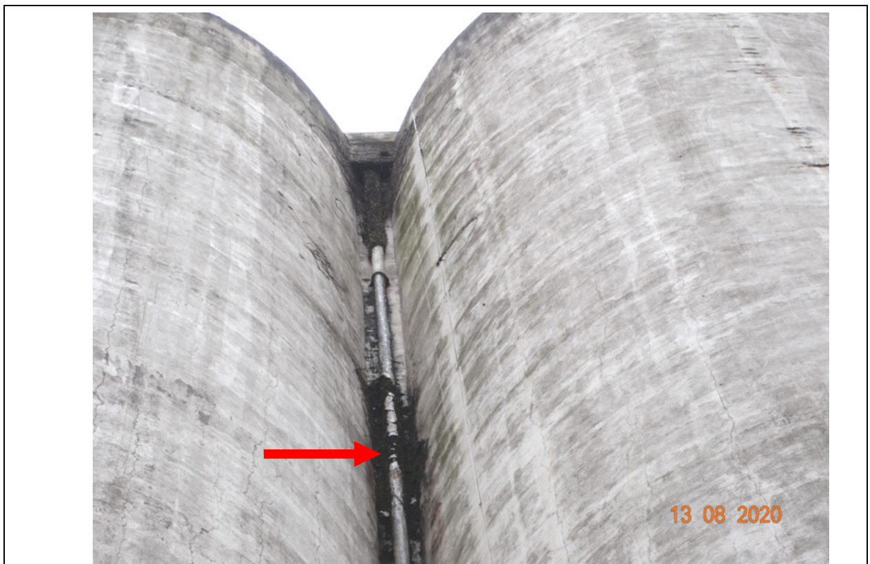
FOTO 26 – OUTRA VISTA DO DUTO DE CAPTAÇÃO DE ÁGUA PLUVIAL NA PARTE SUPERIOR ENTRE OS SILOS. PRESENÇA DE SUJIDADES.
