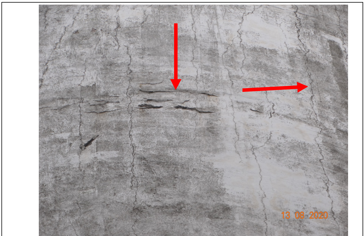
FOTO 24 – DETALHE DA FOTO ANTERIOR. PRESENÇA DE FISSURAS VERTICAIS E HORIZONTAIS GENERALIZADAS NO CONCRETO ARMADO.
