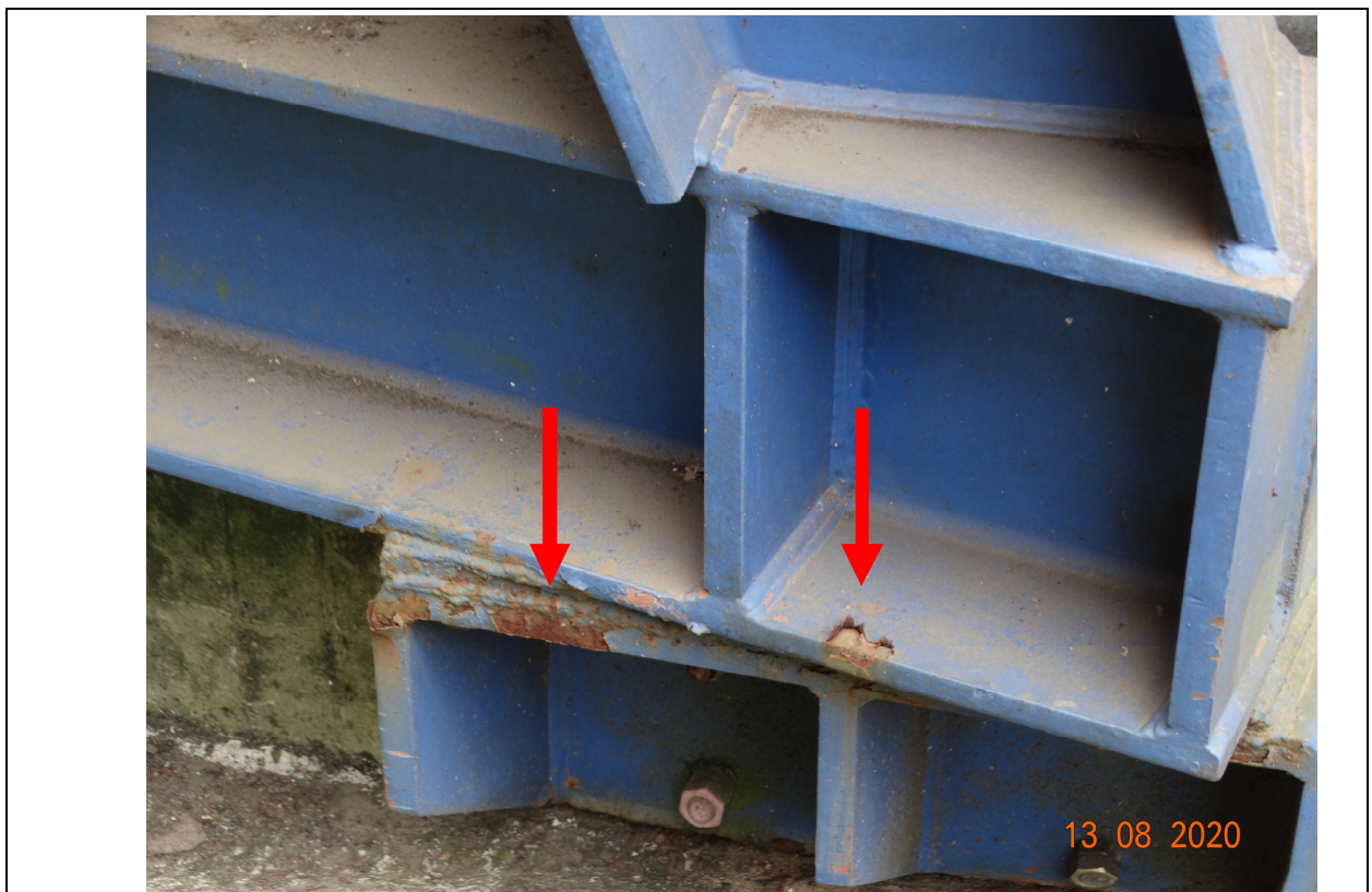
FOTO 16 – DETALHE DA FOTO ANTERIOR Nº 15, NOTA-SE O INÍCIO DE OXIDAÇÃO SUPERFICIAL.
