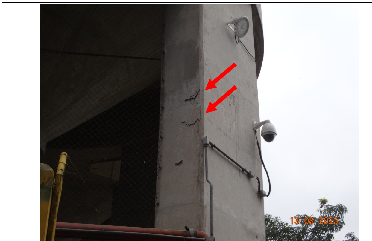
FOTO 31 – INDÍCIOS DE CORROSÃO DE ARMADURA.
