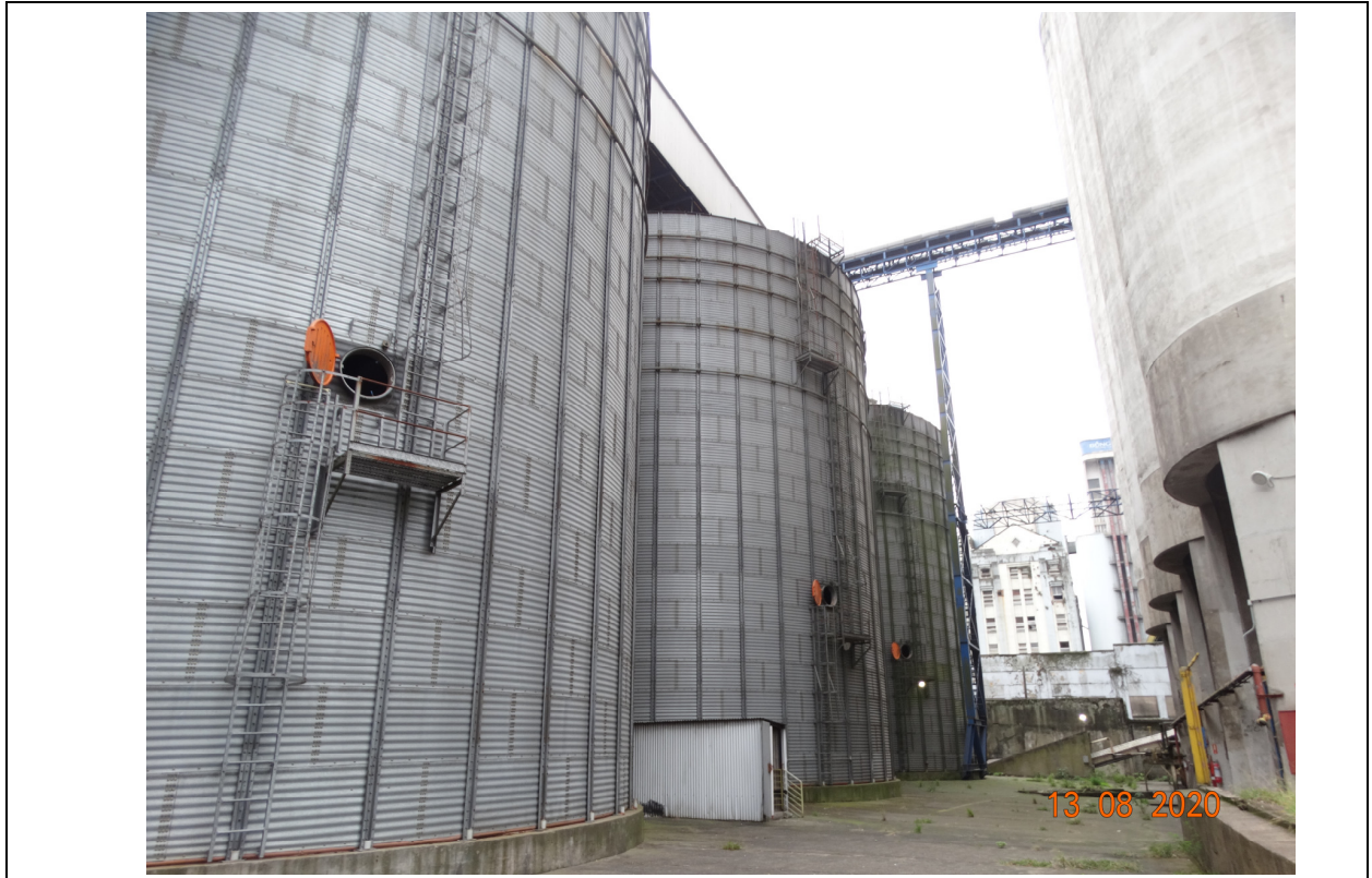
FOTO 35 – VISTA PARCIAL DA ÁREA DE CIRCULAÇÃO ENTRE OS SILOS METÁLICOS E SILOS DE CONCRETO ARMADO.
