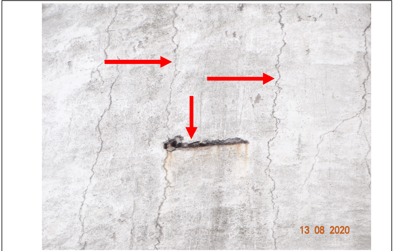
FOTO 29 – DETALHE DA FOTO ANTERIOR Nº 28. PRESENÇA DE FISSURAS VERTICAIS E CORROSÃO DE ARMADURA.
