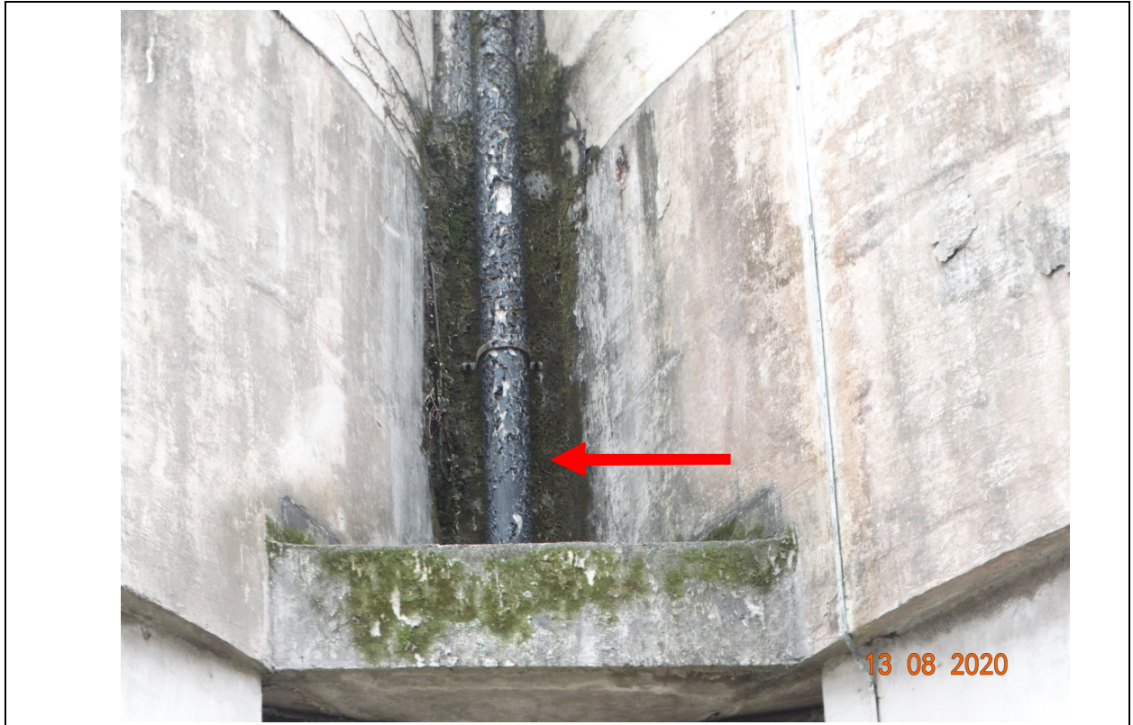
FOTO 25 – VISTA DO DUTO DE CAPTAÇÃO DE ÁGUA PLUVIAL NA PARTE INFERIOR ENTRE OS SILOS. NOTA-SE O ESCORRIMENTO DE SUJIDADES SOBRE A SUPERFÍCIE DE CONCRETO, FORMANDO FUNGOS E LIMO.
