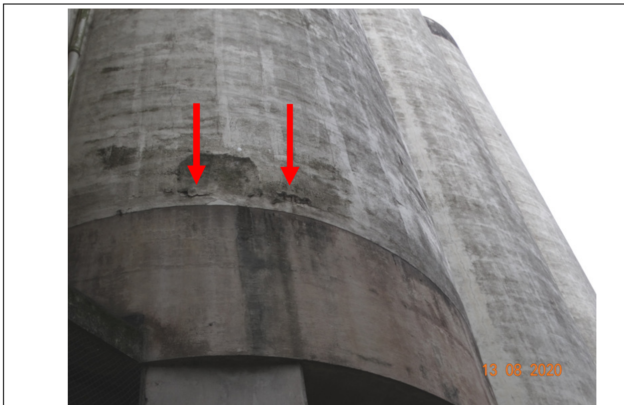
FOTO 21 – DETALHE DA FOTO ANTERIOR Nº 20. NOTA-SE A PRESENÇA DE FISSURA HORIZONTAL E RUPTURA DE CONCRETO.
