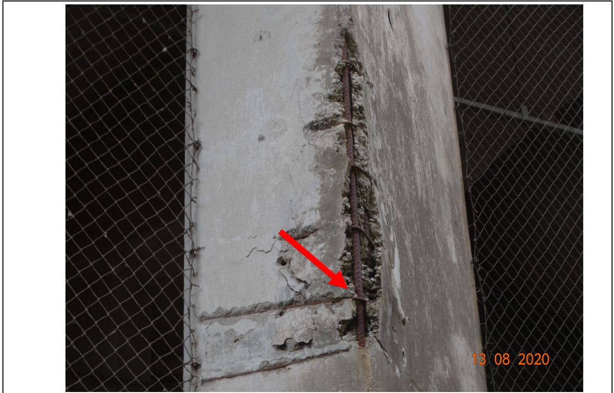
FOTO 19 – DETALHE DA FOTO ANTERIOR Nº 18. PRESENÇA DE ARMADURA EXPOSTA NO PILAR.
