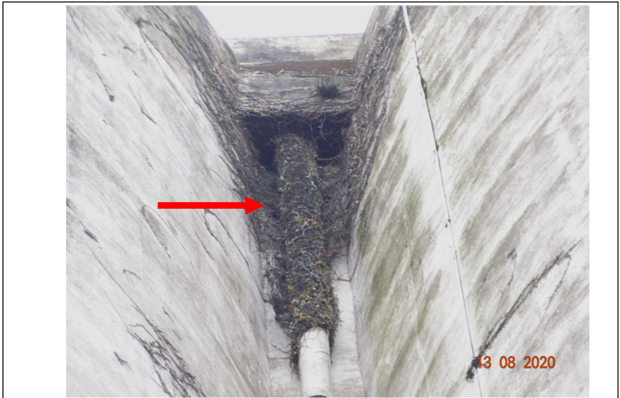
FOTO 27 – DETALHE DA FOTO ANTERIO N° 26. PRESENÇA DE SUJIDADES, VEGETAÇÃO, FUNGOS E LIMO.
