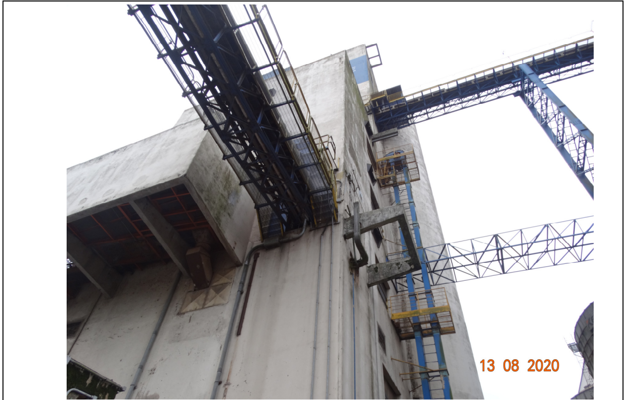
FOTO 05 – VISTA EXTERNA DA EDIFICAÇÃO DE 08 (OITO) PAVIMENTOS DE CONCRETO ARMADO COM ESTRUTURAS METÁLICAS ENGASTADAS (CORREIAS TRANSPORTADORAS).
