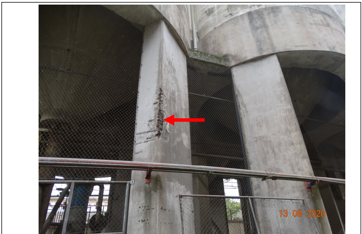
FOTO 18 – RUPTURA E QUEDA DA CAMADA DE COBRIMENTO DE CONCRETO DO PILAR.
