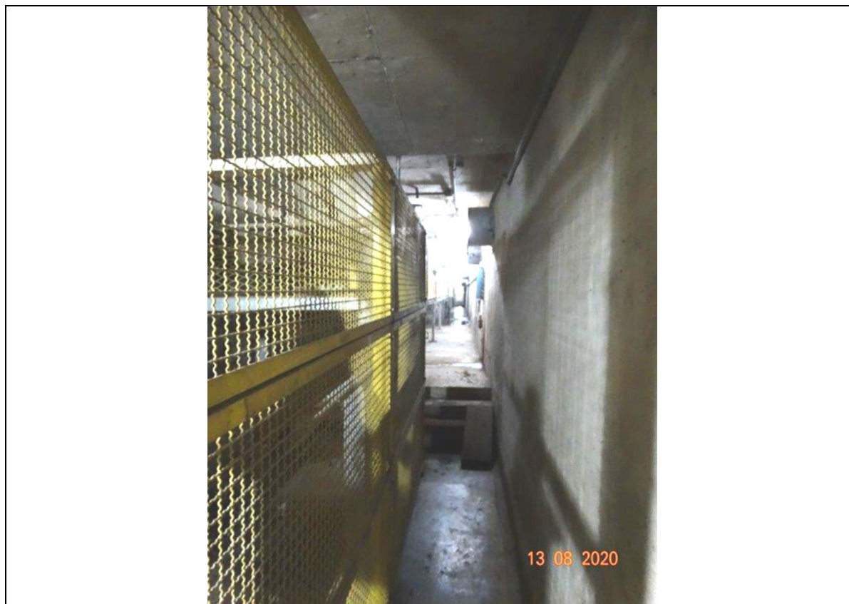
FOTO 76 – SILO 2 - GALERIA SUBTERRÂNEA - ACESSO PERMITIDO SOMENTE EM SUA EXTREMIDADE.
