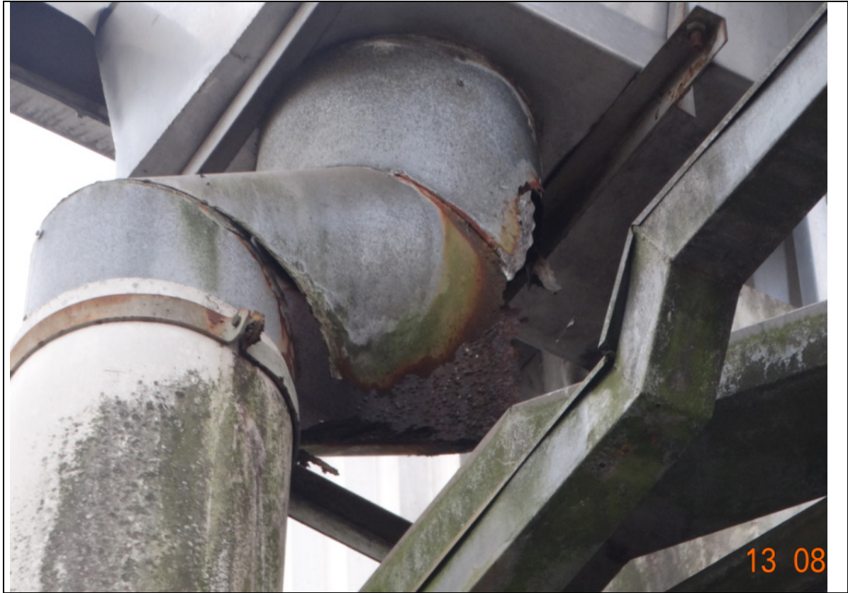
FOTO 69– DETALHE DA FOTO ANTERIOR: CONJUNTO DE PEÇAS DE TUBOS CIRCULARES SOLDADOS, PARA CAPTAÇÃO DA ÁGUA PLUVIAL DO TELHADO ENTRE SILOS. FORAM DANIFICADOS PELA AÇÃO DA CORROSÃO. RECOMENDA-SE REPARAR E INSPECIONAR AS CALHAS DOS TELHADOS.
