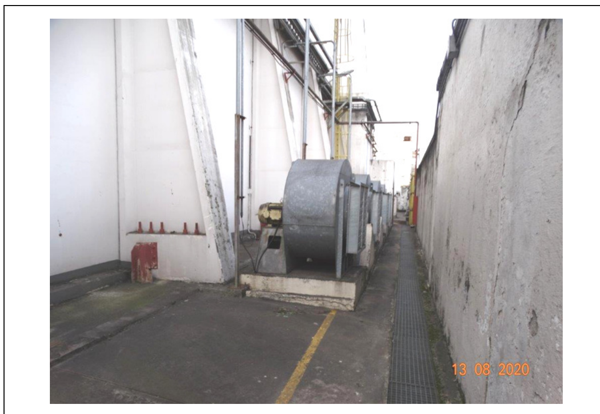
FOTO 77 – VENTILADORES DO SILO 2.
