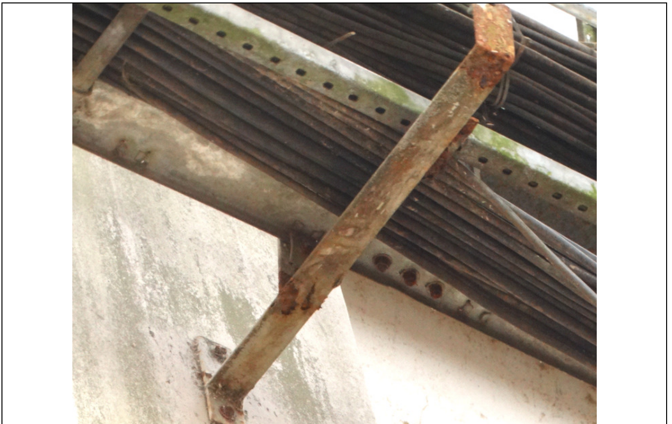
FOTO 15 – DETALHE DA FOTO ANTERIOR: CORROSÃO EM SUPORTE DA ELETROCALHA.
