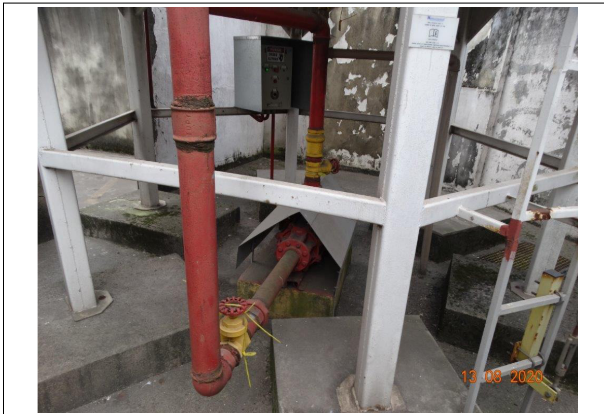
FOTO 55 – BOMBA DE INCÊNDIO.
