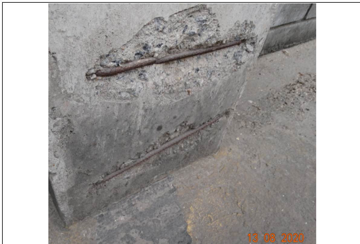
FOTO 37 – DETALHE DA FOTO ANTERIOR: PARTE INFERIOR DO PILAR COMO CORROSÃO EM DOIS ESTRIBOS.
