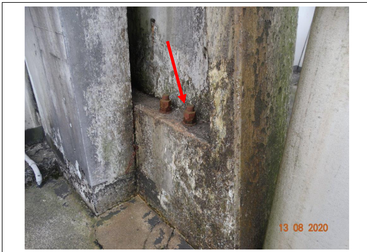
FOTO 59 – DETALHE DA BASE DO SILO NO MESMO TRECHO DA FOTO ANTERIOR: SUJIDADES.
