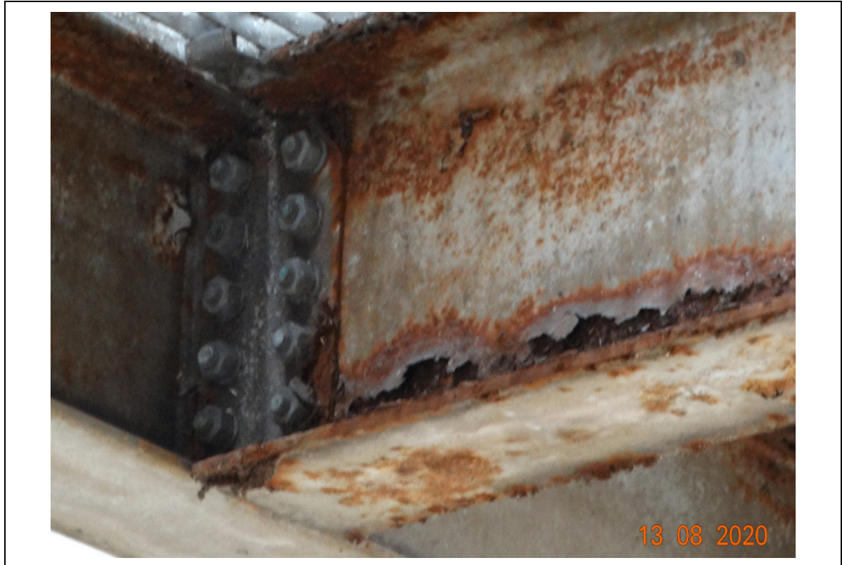
FOTO 20 – DETALHE DA FOTO ANTERIOR: PEÇAS METÁLICAS DA ESTRUTURA COM CORROSÃO.
