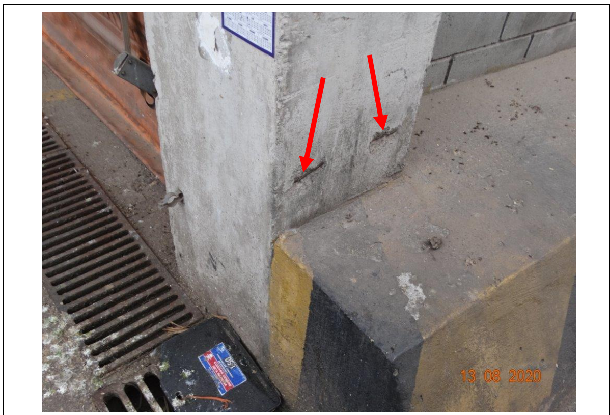
FOTO 34 – DETALHE DA FOTO ANTERIOR: PARTE INFERIOR DO PILAR COMO CORROSÃO EM UM ESTRIBO.
