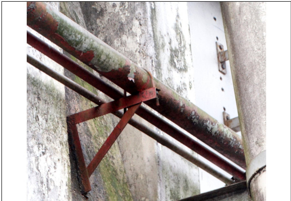
FOTO 62 – DETALHE DE FOTO ANTERIOR: ALGUNS TRECHOS EXTERNOS DE TUBULAÇÃO DE HIDRANTE (NA COR VERMELHA) NECESSITAM SER REPINTADOS, POIS ESTÃO PARCIALMENTE SEM CAMADA DE PINTURA NA COR OBRIGATORIA.
