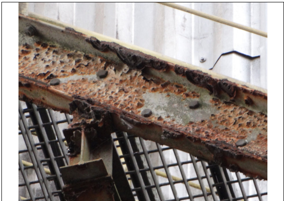
FOTO 25 – DETALHE DA FOTO ANTERIOR: PEÇAS METÁLICAS DA ESTRUTURA (VIGA DA ESCADARIA) COM CORROSÃO.
