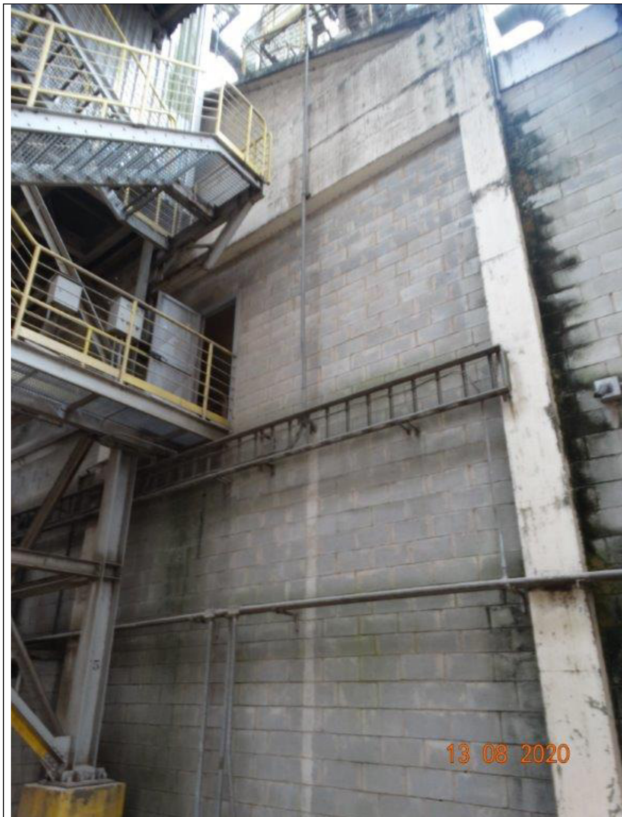
FOTO 17 – PAREDE EXTERNA DA ÁREA DE CARREGAMENTO DE CAMINHÕES, EM FRENTE AOS SILOS 1/2.
