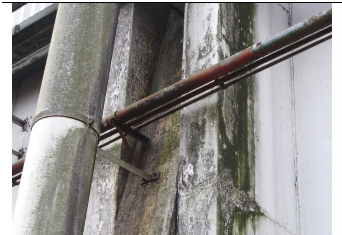
FOTO 58 – DETALHE DE FOTO ANTERIOR: ESCORRIMENTO DE SUJIDADES SOBRE A SUPERFÍCIE DO CONCRETO, FORMANDO FUNGOS E LIMO.
