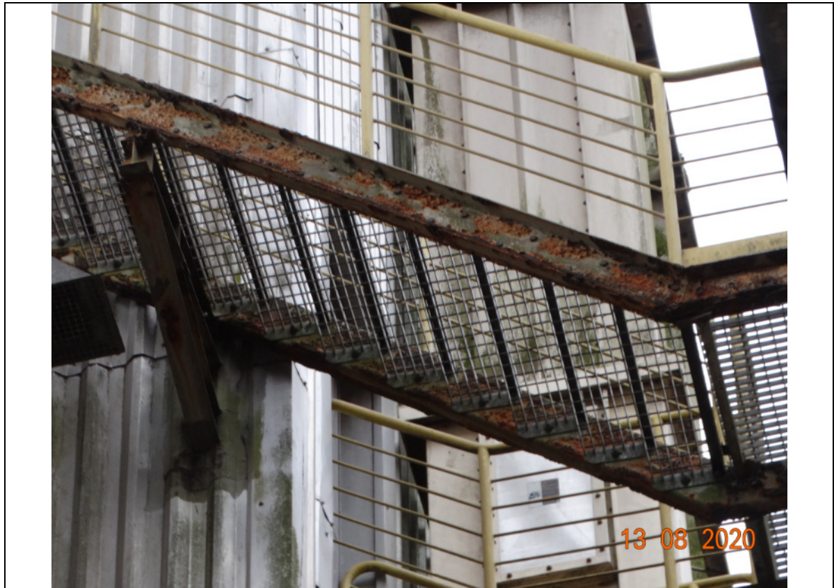
FOTO 24 – DETALHE DA FOTO ANTERIOR: ESCADARIA METÁLICA COM CORROSÃO.
