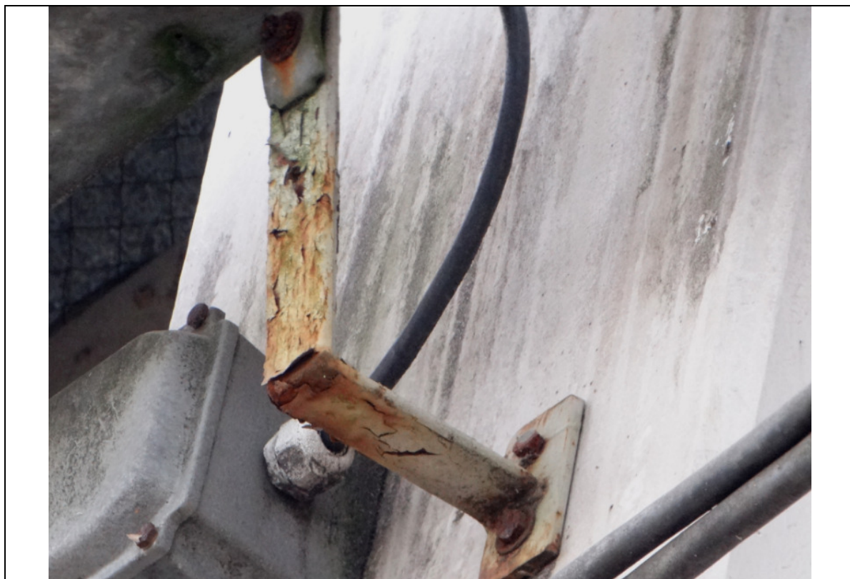
FOTO 67 – DETALHE DA FOTO ANTERIOR: PEÇA METÁLICA DE APOIO DA ELETROCALHA COM CORROSÃO SUPERFICIAL.
