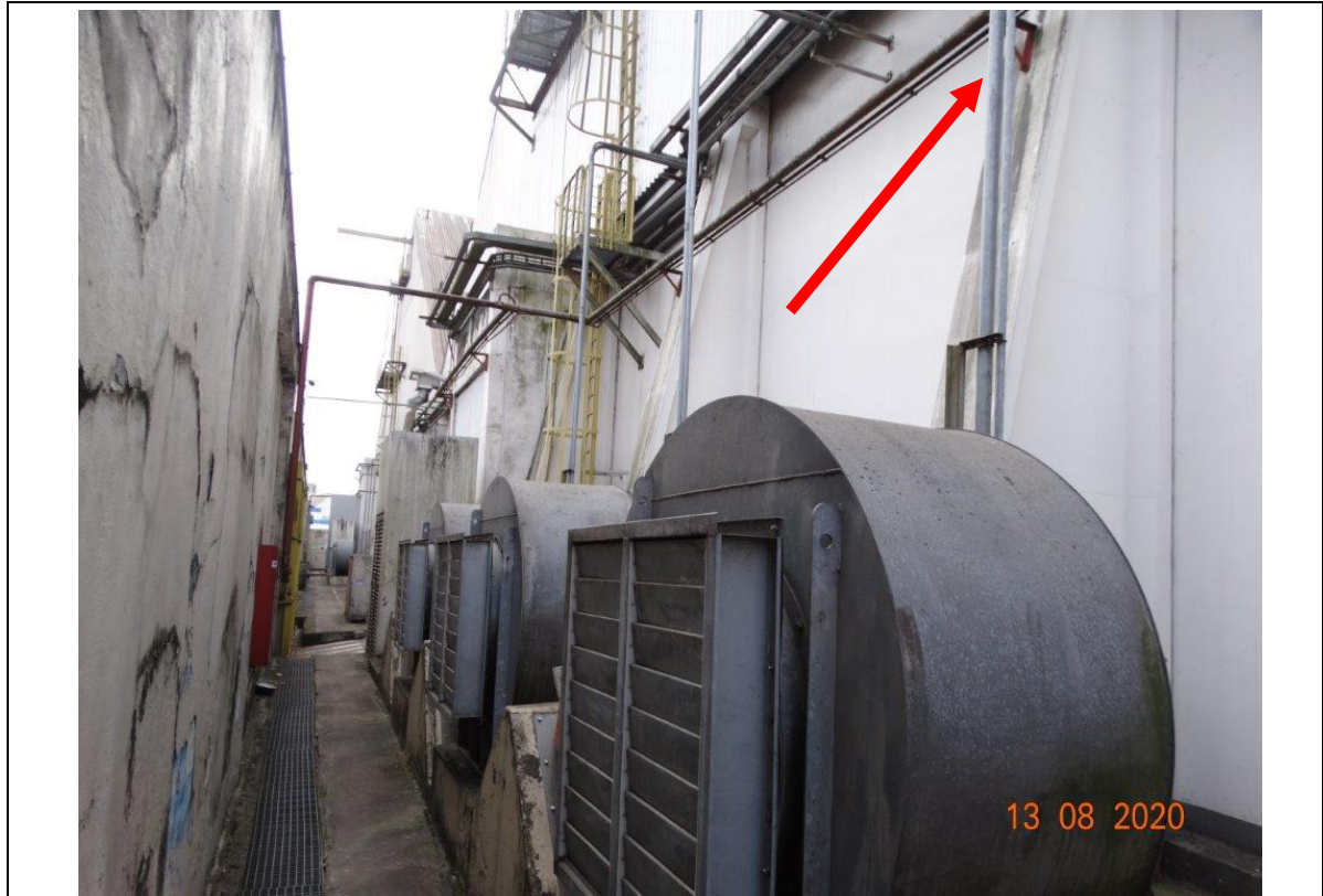
FOTO 61 – MOTORES DE VENTILAÇÃO.
