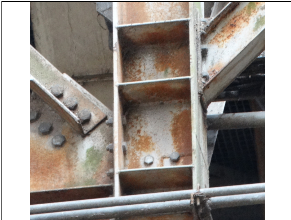
FOTO 22 – DETALHE DA FOTO ANTERIOR: PEÇAS METÁLICAS DA ESTRUTURA COM CORROSÃO.
