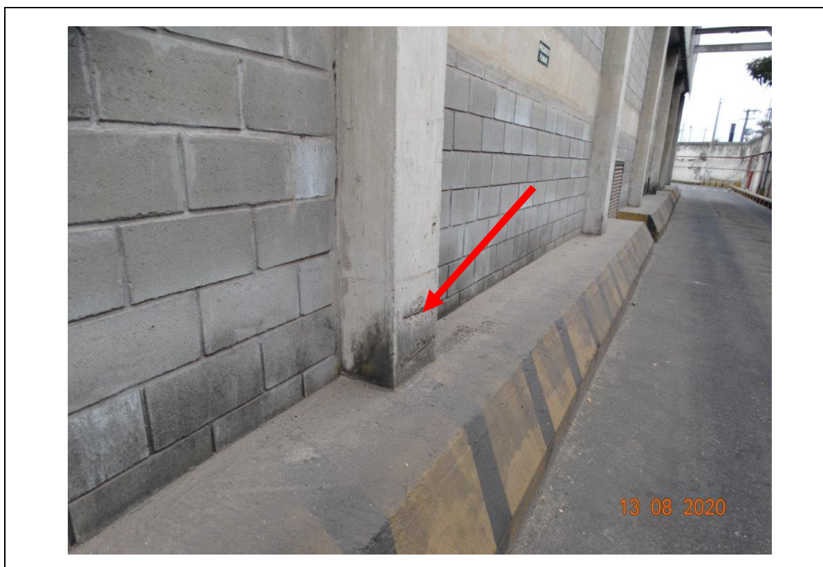
FOTO 36 – DETALHE DA FOTO 33.
