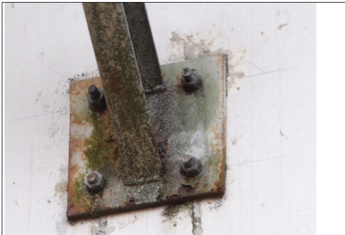
FOTO 65 – DETALHE DA FOTO ANTERIOR: PEÇA METÁLICA DA ESTRUTURA DE APOIO DA ESCADARIA COM CORROSÃO SUPERFICIAL.
