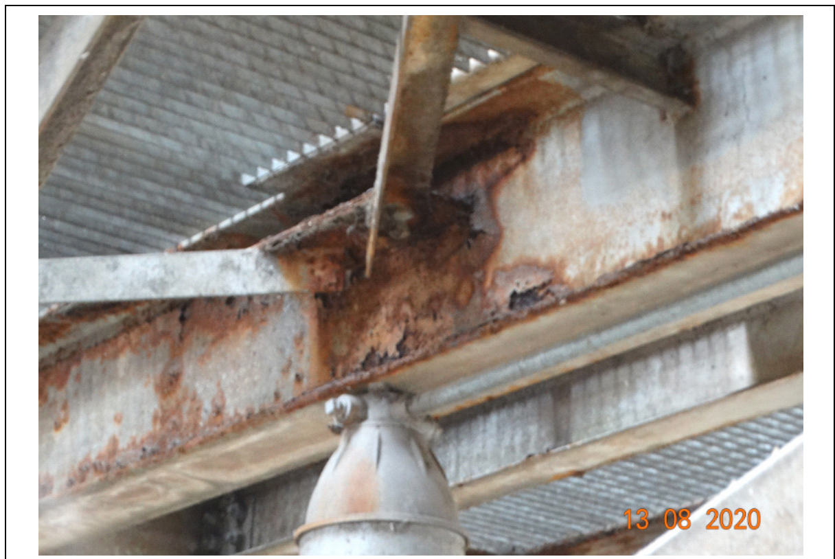
FOTO 19 – DETALHE DA FOTO ANTERIOR: PEÇAS METÁLICAS DA ESTRUTURA E SEUS ACESSÓRIOS (PORCAS, ARRULEAS), COM CORROSÃO.
