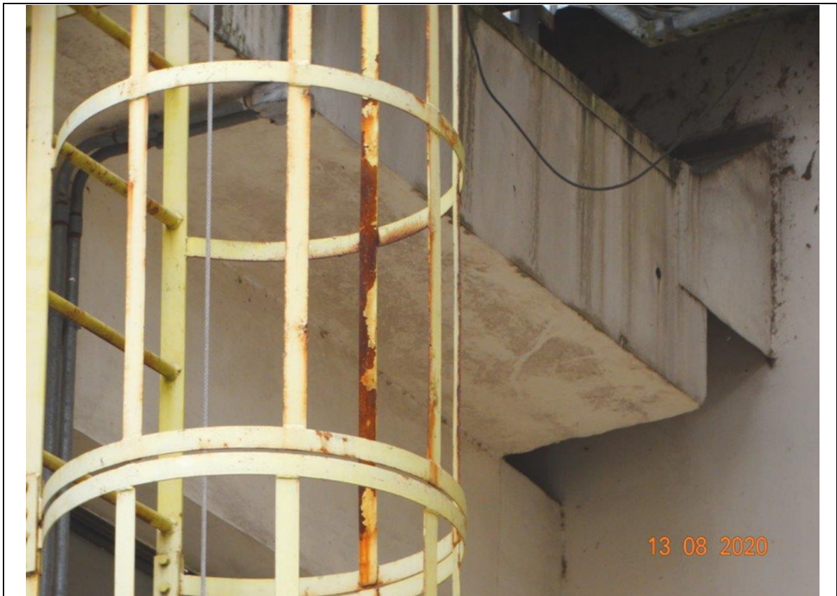
FOTO 09 - DETALHE DA FOTO ANTERIOR: ALGUMAS PEÇAS METÁLICAS APRESENTAM EXTENSA CORROSÃO SUPERFICIAL.
