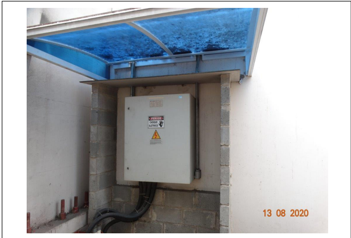
FOTO 48 – PAINEL ELÉTRICO JUNTO AO SILO 3.
