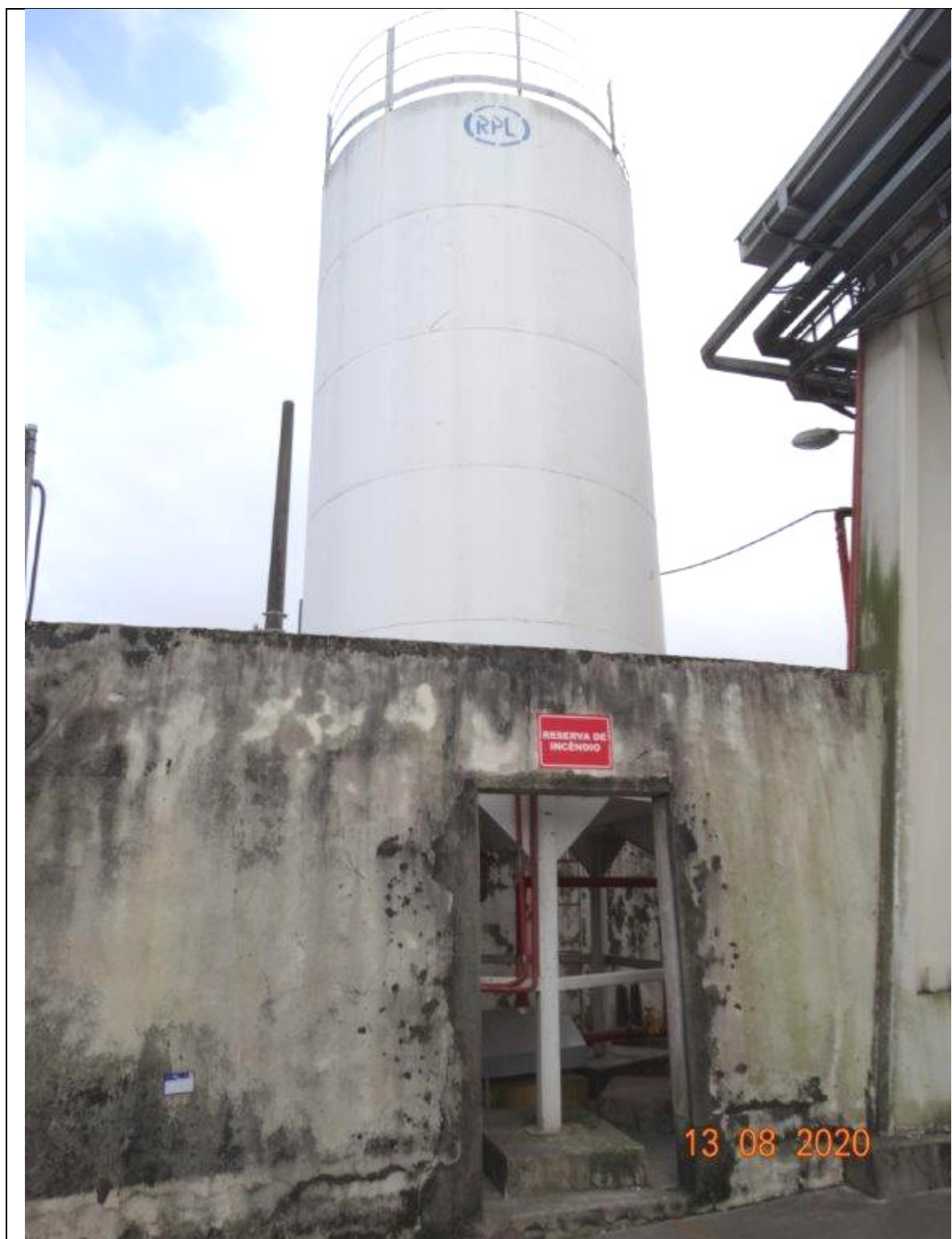
FOTO 54 – RESERVATÓRIO DA RESERVA DE INCÊNDIO.
