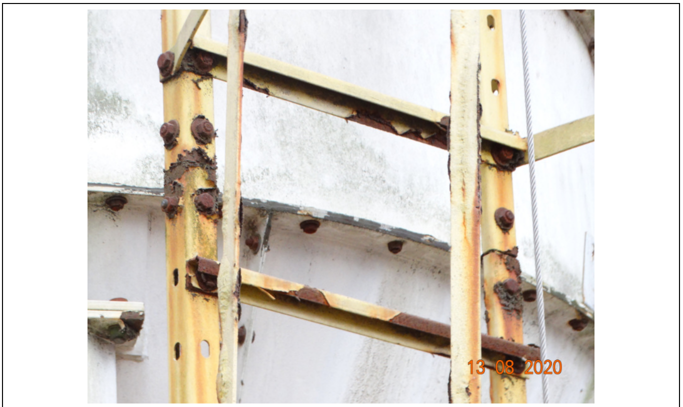
FOTO 11 – DETALHE DA FOTO ANTERIOR: PEÇAS METÁLICAS DA ESTRUTURA E SEUS ACESSÓRIOS (PORCAS, ARRULEAS), COM CORROSÃO.
