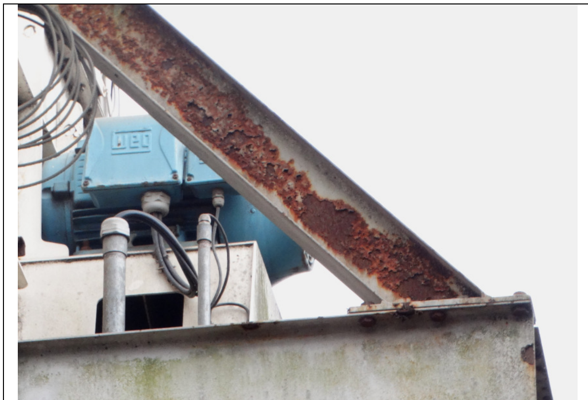
FOTO 39 – DETALHE DA FOTO ANTERIOR: PEÇA METÁLICA DA ESTRUTURA DE SUPORTE COM CORROSÃO.
