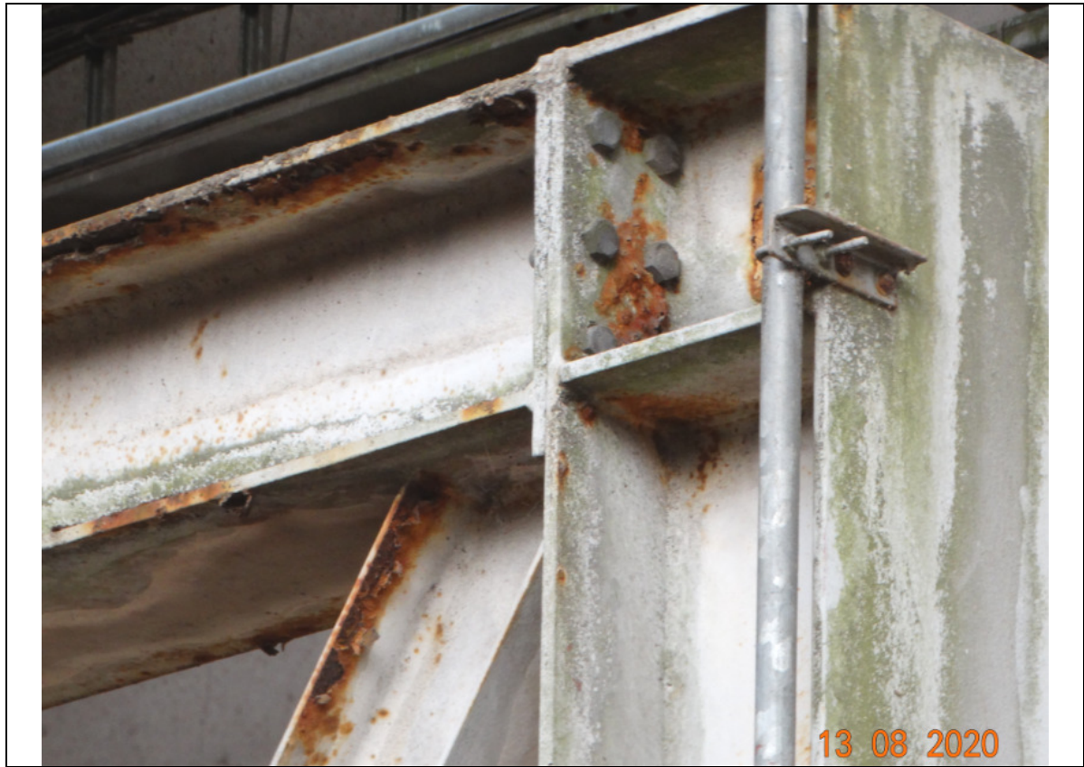
FOTO 29 – DETALHE DA FOTO ANTERIOR: PEÇAS METÁLICAS DA ESTRUTURA COM CORROSÃO.
