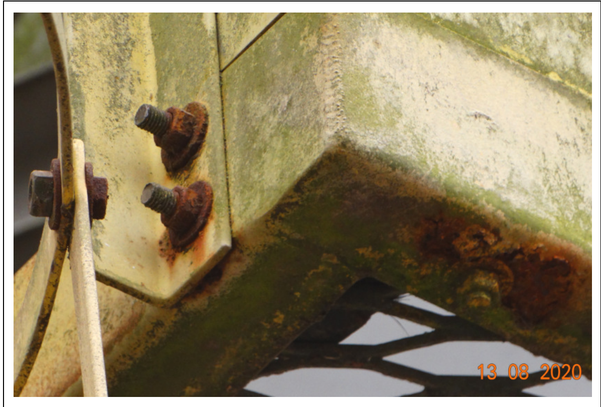
FOTO 10 – DETALHE DA FOTO ANTERIOR: PEÇAS METÁLICAS DA ESTRUTURA E SEUS ACESSÓRIOS (PORCAS, ARRULEAS), COM CORROSÃO.
