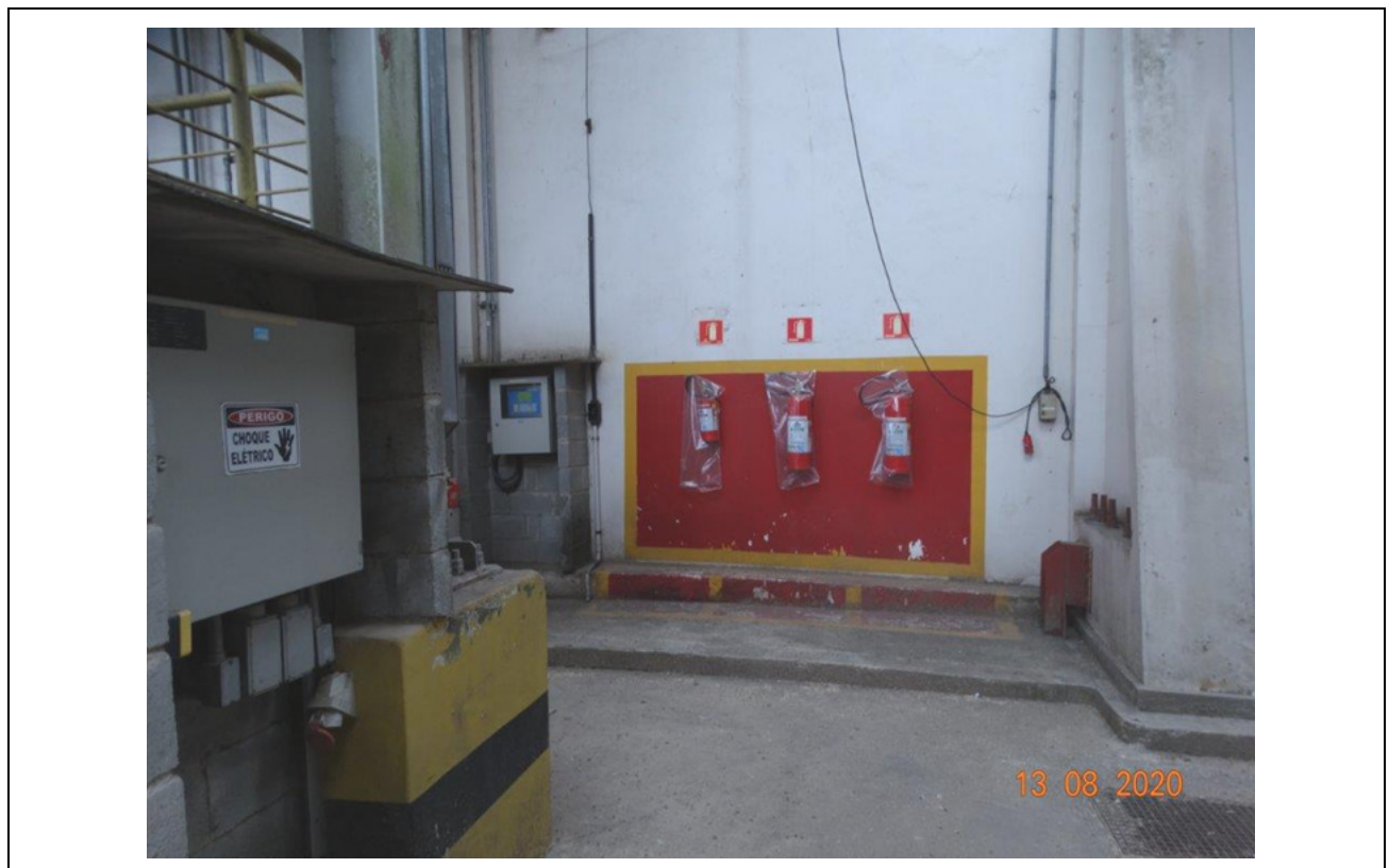
FOTO 13 – INSTALAÇÕES DE QUADROS DE DISTRIBUIÇÃO DE ENERGIA E EXTINTORES.
