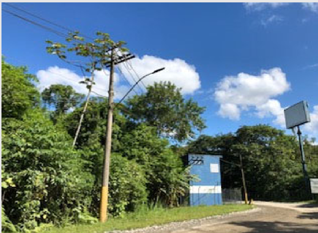
Foto 29: Cabine Primária na entrada do aterro.
