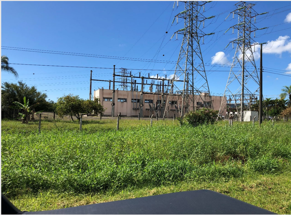
Foto 35- Vista Frontal subestação Vicente de Carvalho.
