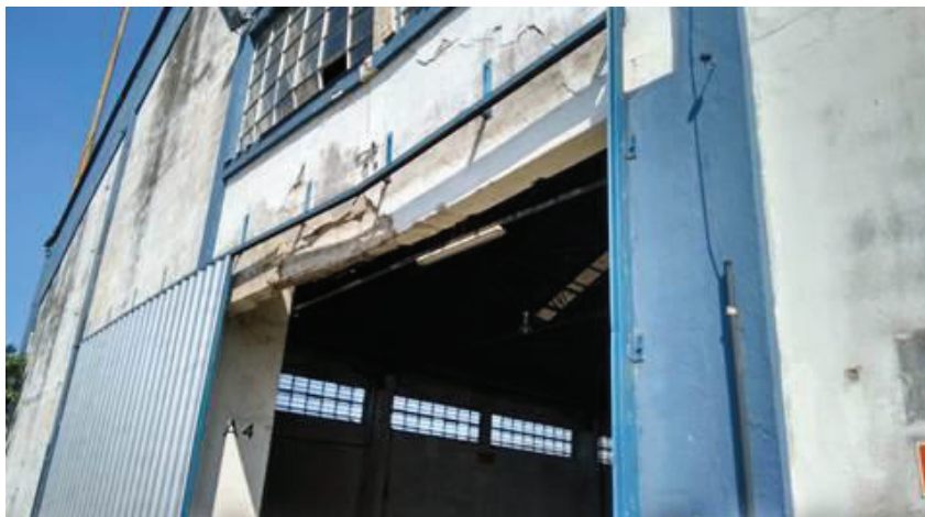
Figura 18 – Visão da viga de sustentação com risco de desabamento. Fonte: Adaptado Google Earth (2016).
