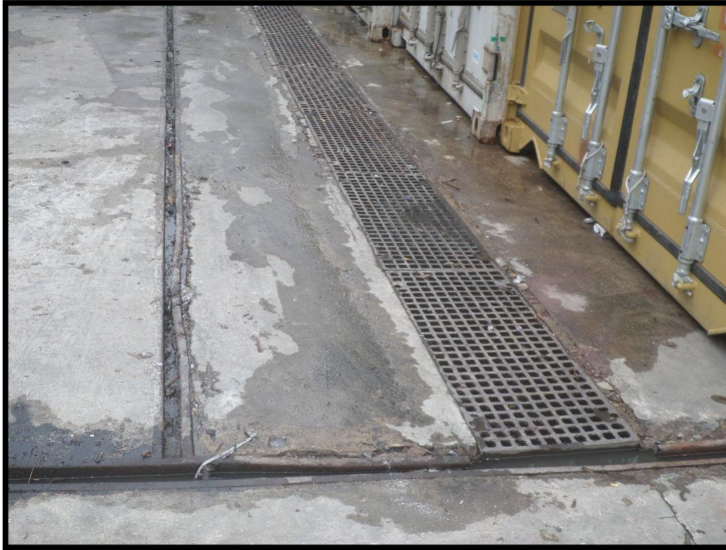
Foto 15 - Área de lavagem de contêiner. Fonte: Engea, 2019.
