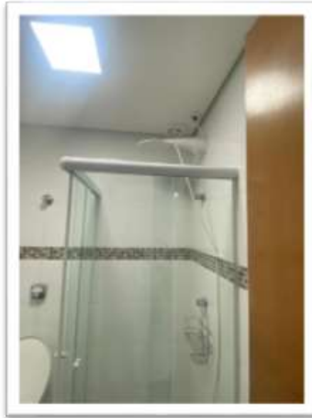
Foto 11- Sistema de exaustão sanitários –Arquivo Pessoal
