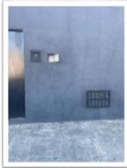
Foto 08– Entrada cavalete sabesp –Arquivo Pessoal
