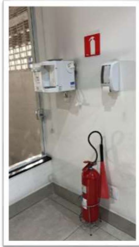
Foto 15- Equipamento de segurança contra incêndio –Arquivo Pessoal
