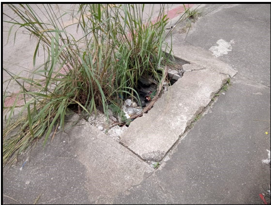
Imagem 55 - Rede de drenagem na Avenida Marginal da Via Anchieta, rede obstruída com lixo.
