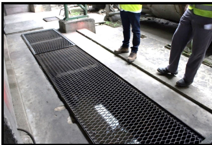
Imagem 33 - Início da área de tratamento - Caixa SAO.
