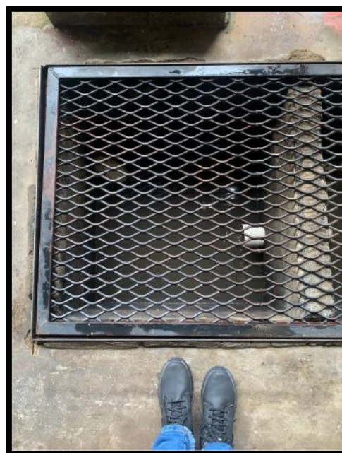
Imagem 31 - Passagem final da água, aqui o resíduo é direcionado ao Rio São Jorge, ao qual passa atrás do empreendimento.
