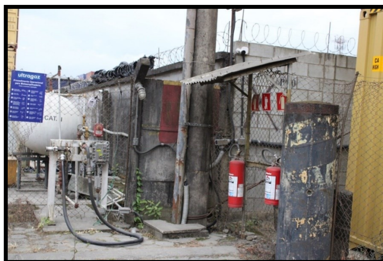
Imagem 40 - Área para abastecimento de gás, com a presença de equipamentos de segurança.
