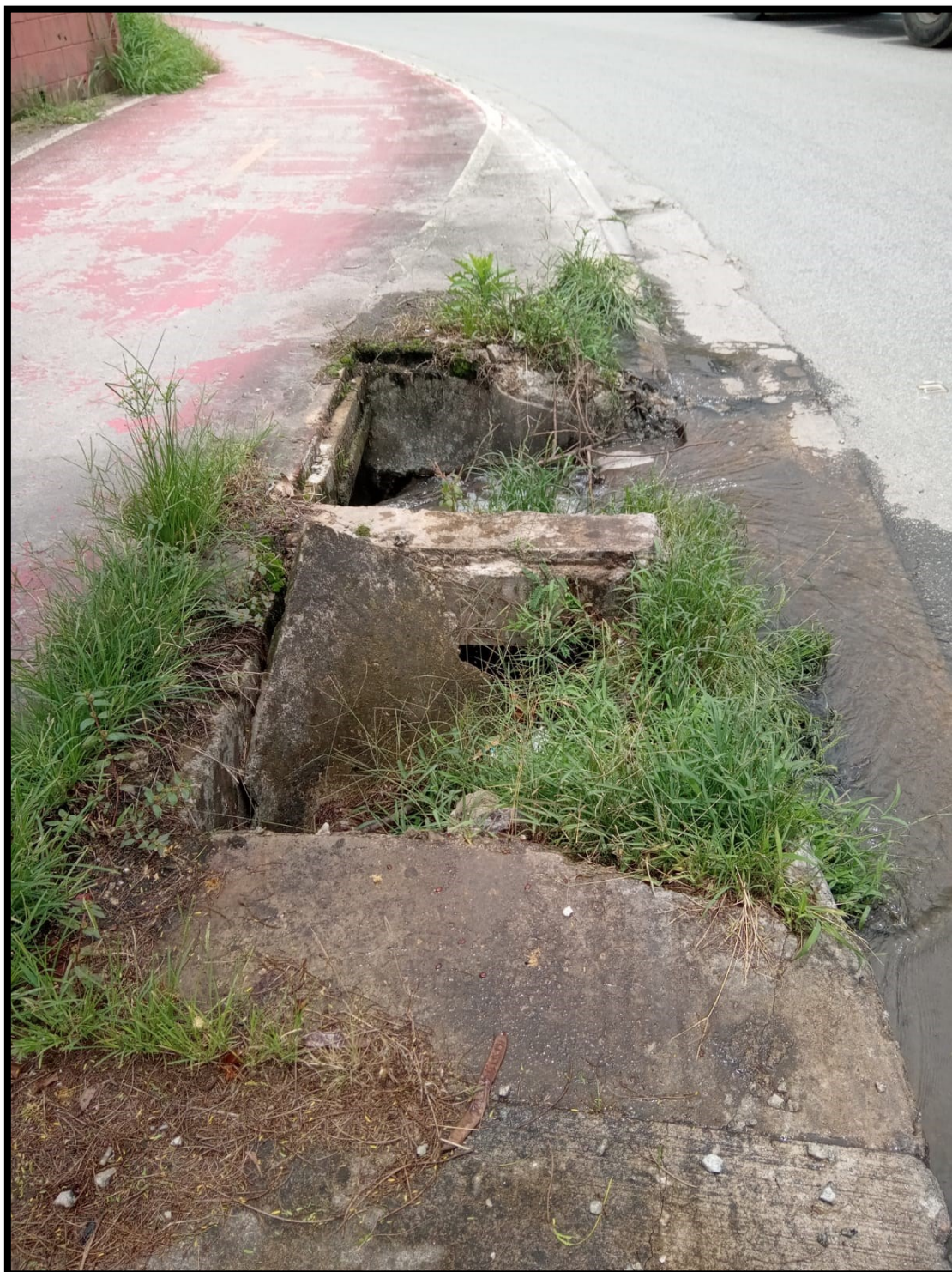
Imagem 54 - Rede de drenagem próxima ao empreendimento. Observa-se que a caixa se encontra destruída e com vegetação.
