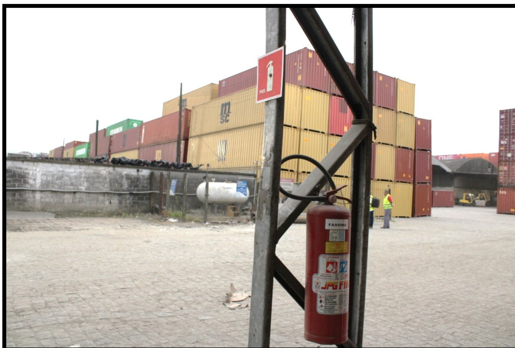
Imagem 59 - Sistema de Combate ao Incêndio – Tendas de sacarias.
