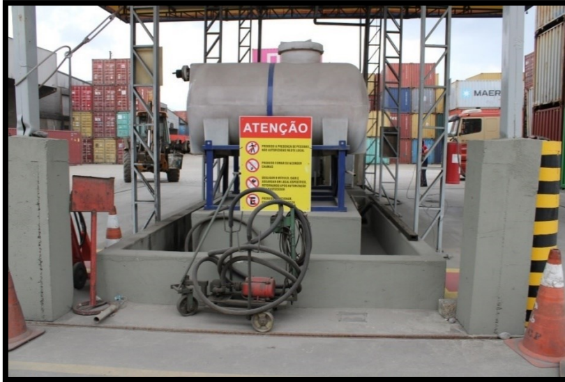
Imagem 36 - tanque aéreo de óleo hidráulico – 1.500 litros; 01 (um) tanque aéreo de óleo de motor – 1.500 litros, com dique de contenção.
