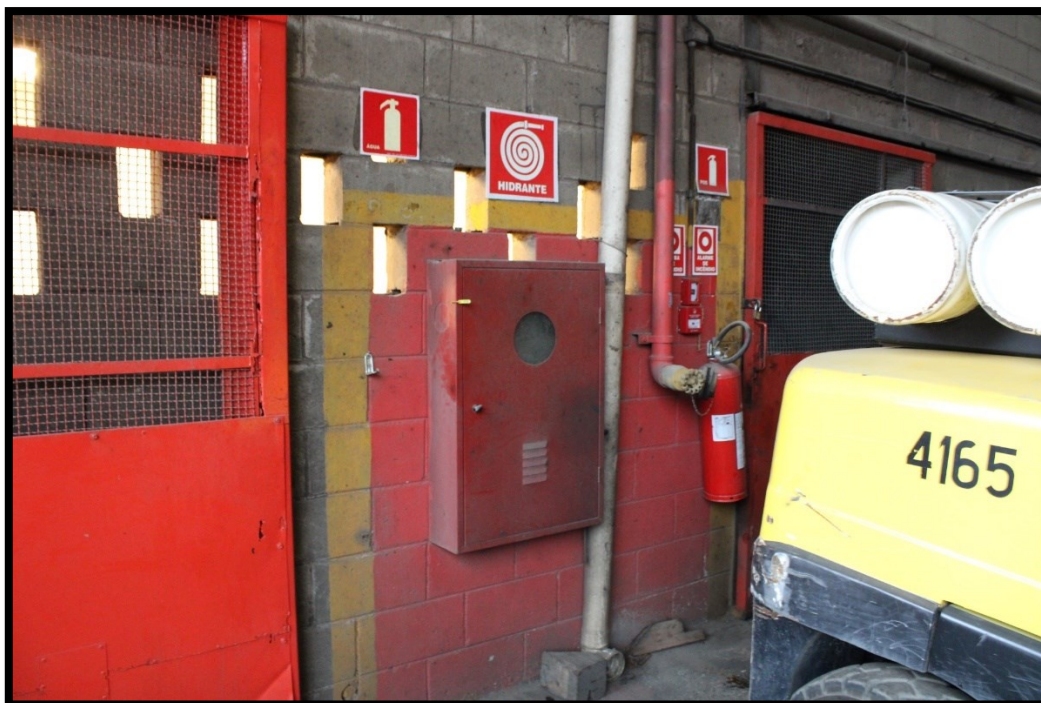
Imagem 58 - Sistema de combate a incêndio - Manutenção e lavagem de empilhadeiras.
