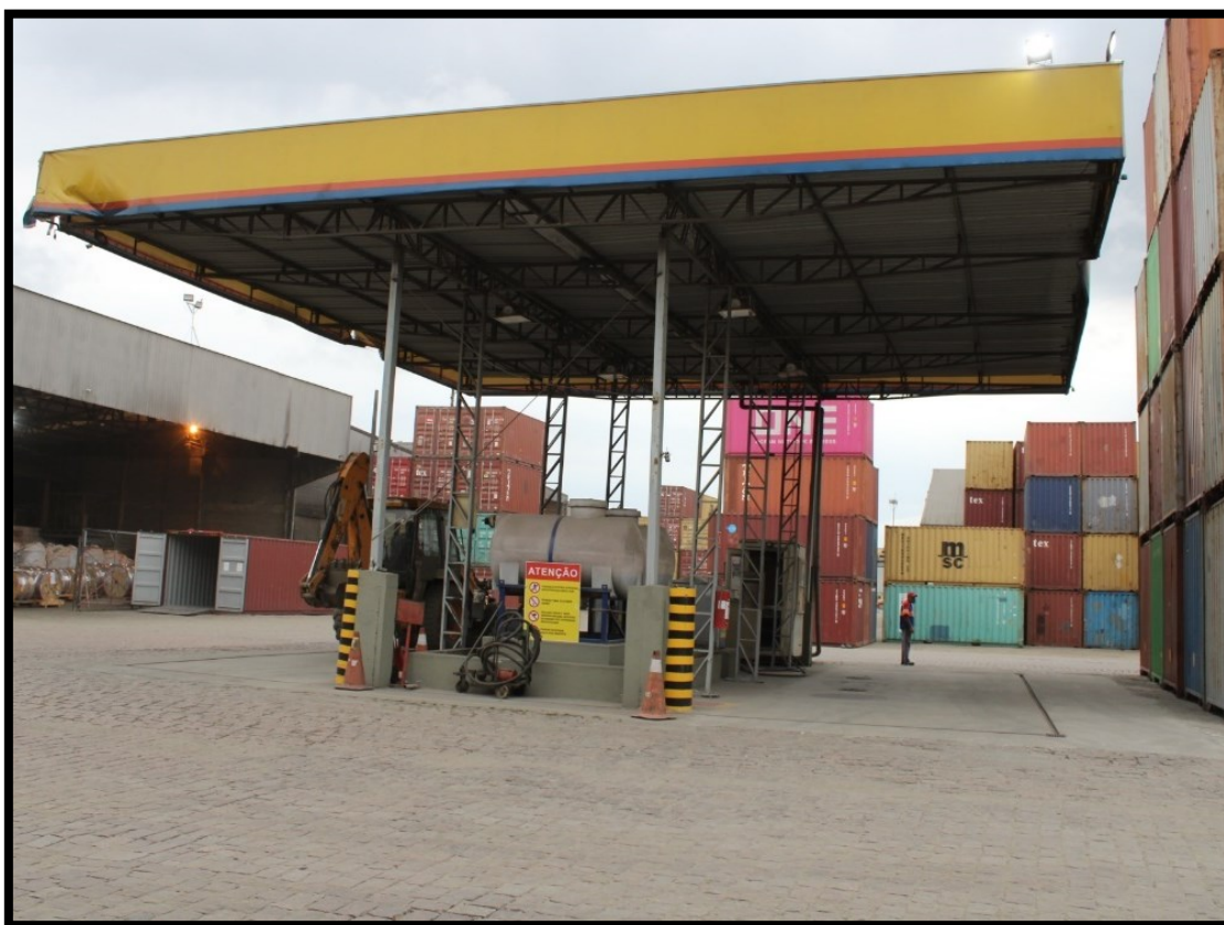
Imagem 35 - Posto de abastecimento de diesel. A área conta com sistema de retenção e direcionamento da água da chuva, além de canaletas e dique de contenção.
