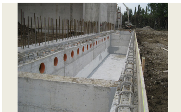
Foto 08: Caixa de Distribuição de ar (plenum).
