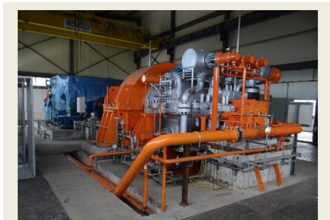
Foto 21: Exemplo de Turbina de Condensação
