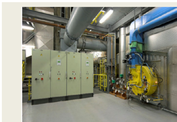
Foto 19 – Queimadores de Combustível Auxiliar.
