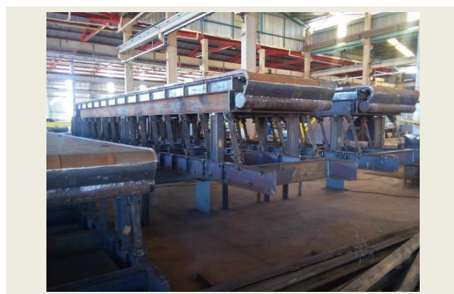
Foto 18– Exemplo da grelha de combustão.
