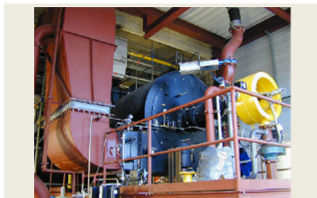
Foto 20 – Queimadores de Combustível Auxiliar.
