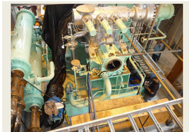
Foto 22: Exemplo de Turbina de Condensação
