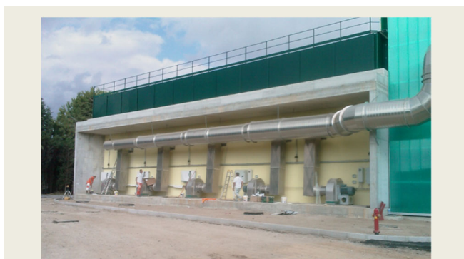
Foto 11: Sistemas de oxigenação e aspiração do ar dos bioestabilizadores.
