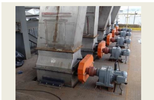
Foto 17 – Alimentador de Combustível e Bica de Alimentação.
