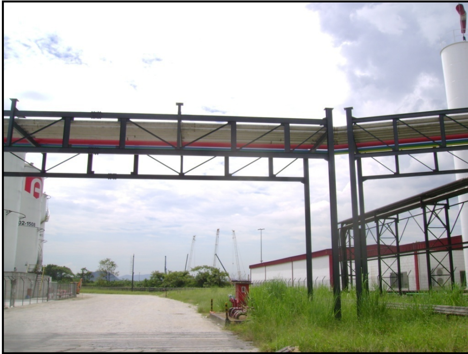
Figura 2.2 – Foto do pipe-rack
