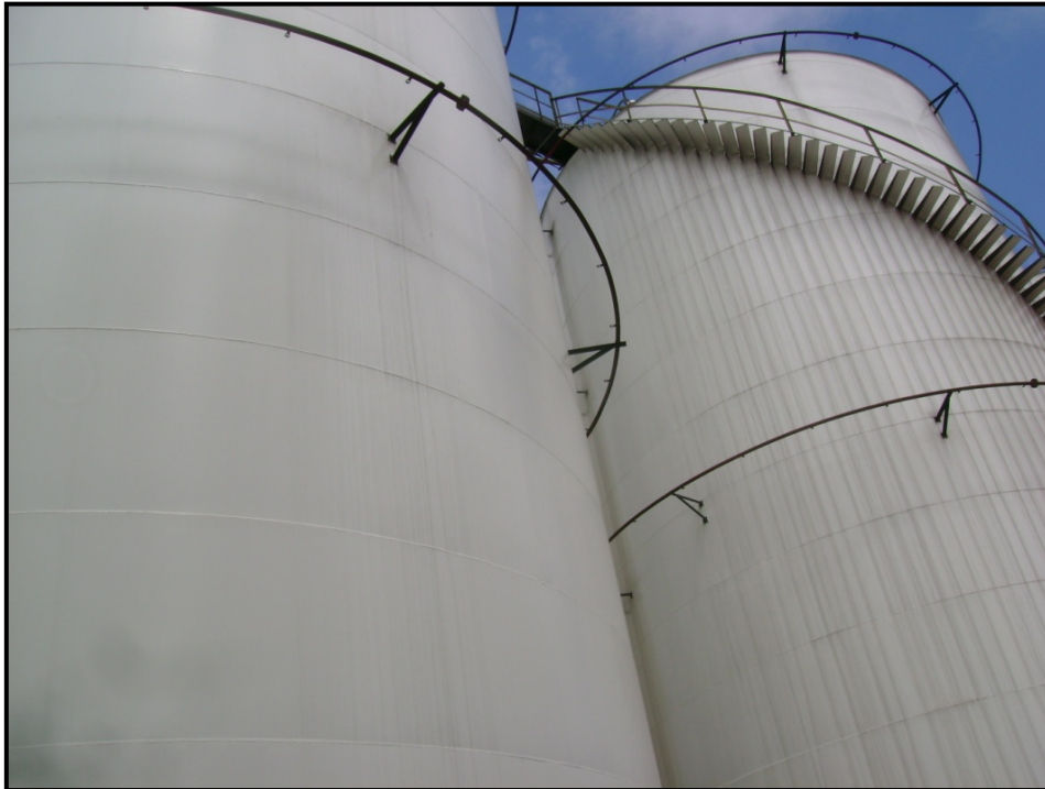
Figura 2.3 – Tanques de armazenamento com anéis aspersores
