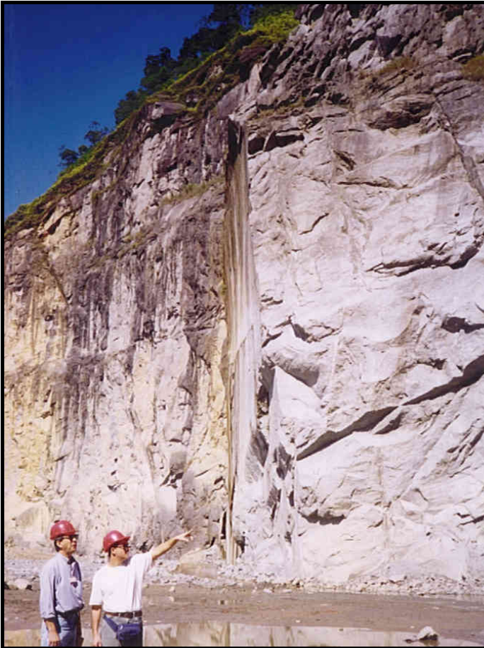
FOTO 2.1.5.2 - Tomada em detalhe do maciço rochoso porção NW-W da cava. Verifica-se boa estabilidade com talude em alto ângulo.
