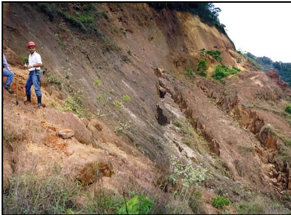
FOTO 2.1.2.1 - Tomada em detalhe ao talude em solo junto ao setor SW-W verifica-se espessura superior a 15 metros e sulcos de erosão por águas superficiais em desenvolvimento.
