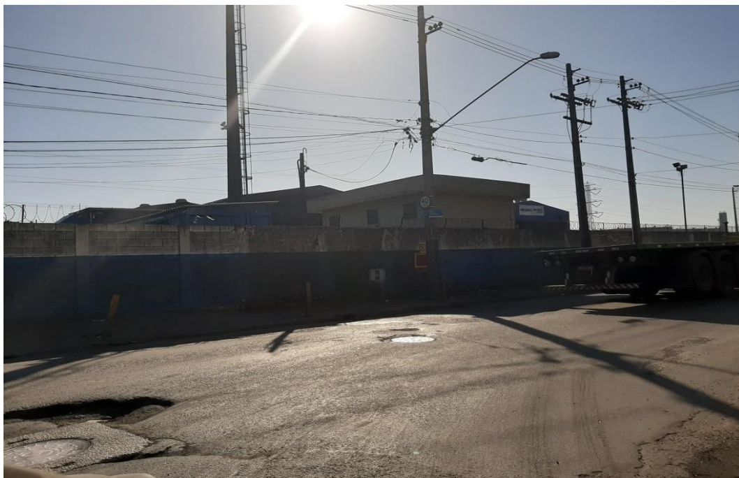
Figura 41 – Situação do asfalto na R. Dr. Albert Schweitzer com patologias diversas.
