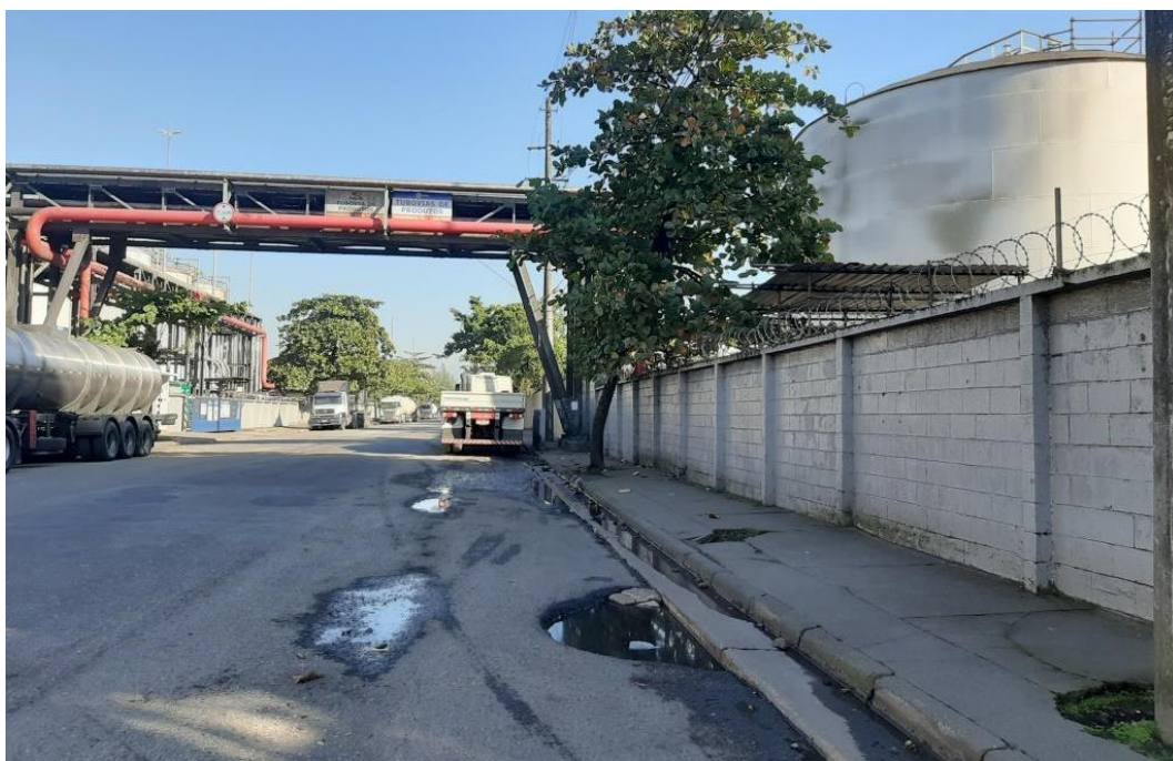
Figura 40 – Vista da R. Aurélio Batista Félix, com danos no pavimento e calçadas.
