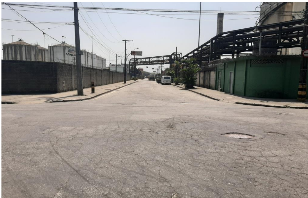
Figura 46 – Vista da R. Eustáquio Alves de Souza com patologias no pavimento.
