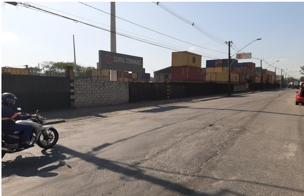
Figura 43 – Destaque recorrente da condição do revestimento asfáltico na via.
