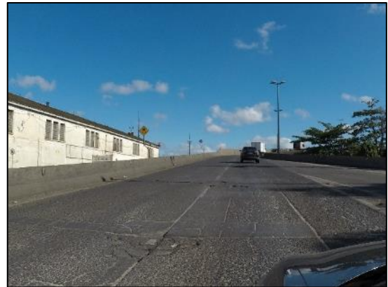
Foto 2.14: Trecho inicial do viaduto de saída da área STS11. O dispositivo possui sentido único de direção, com duas faixas de rolamento. A partir da imagem nota-se as condições inadequadas de conservação do pavimento e da sinalização viária no viaduto.
