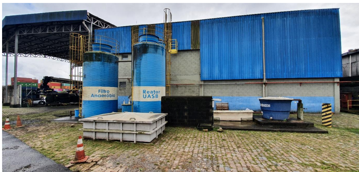
Figura 18: Estação de Tratamento de Efluentes (ETE) Biológica do Terminal CLIA Santos
