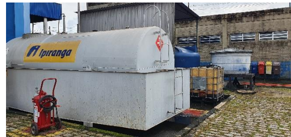
Figura 14: Detalhe do tanque de armazenamento de combustível (diesel)
