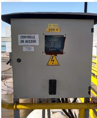
Figura 25: Controle de acesso Armazém 29 (foto 1)
