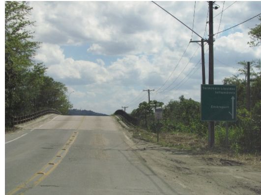
Foto 2.6. | Trecho inicial de Obra de Arte Especial (OAE) sobrepondo curso d’água existente no local. No total, a Estrada Particular da CODESP possui duas OAE’s.
