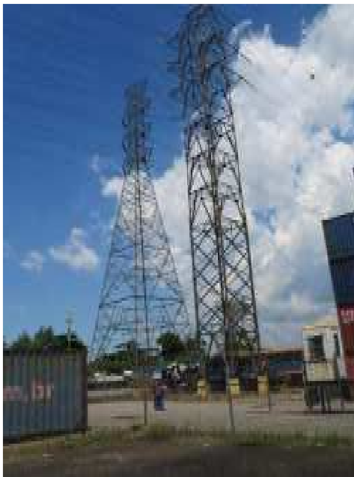
Figura 13 - Vista parcial das torres de distribuição de energia
