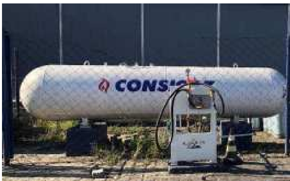
Figura 12 - Área destinada para armazenamento de GLP
