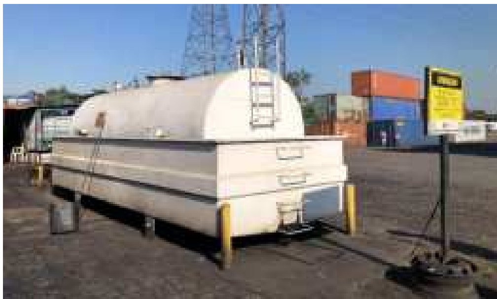
Figura 11 - Tanque aéreo com bacia de contenção
