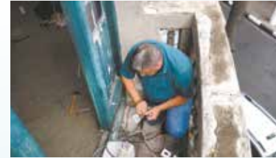
Fonte para iluminação das bandeiras do prédio da Seges - Centro
