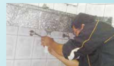
Troca de válvula de lavatório de pia da UME Colégio Santista - Vila Nova
