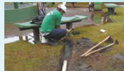
Sistema de drenagem da Praça Encarnacion Alves Corpas - Caruará
