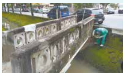
Manutenção da passarela da Av. Moura Ribeiro com Rua Saturnino de Brito - Marapé
