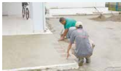
Reparo no piso na área de estacionamento da Base Comunitária da PM - Caruará
