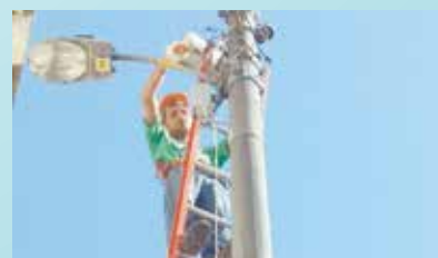
Instalação de ponto de luz na Rua Santo Antônio do Valongo - São Bento
