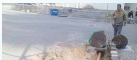
Sistema de esgoto do Arena Santos - Vila Mathias
