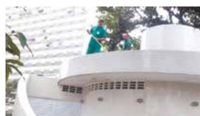
Limpeza da laje sobre os sanitários dos quiosques da orla da praia
