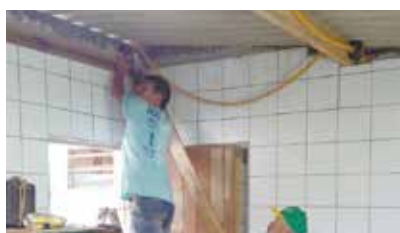
Madeiramento para instalação de forro em PVC da cozinha da Soc. Esportiva do Caruara
