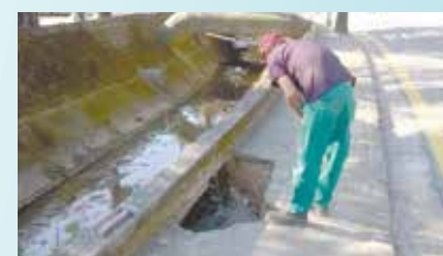
Reparo em Buraco da Av. Nilo Peçanha com Rua Carvalho de Mendonça - Marapé
