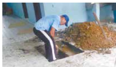
Reparo e desentupimento da caixa de gordura e fossa da UME Monte Cabrão
