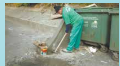
Reparo em baia para colocação de contentores na Rua São Roque - São Bento
