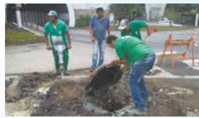
Renivelamento de poço de visita na Rua Professor Celso da Cunha Alves - Jabaquara
