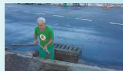
Reparo em abatimento na Av. Bartolomeu de Gusmão - Aparecida
