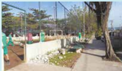
Demolição da mureta de fechamento do campo na Praça Eusébio Rocha - São Manoel
