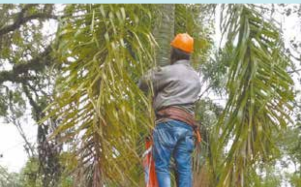
Instalação de 2 caixas de luz na Lagoa da Saudade - Morro Nova Cintra
