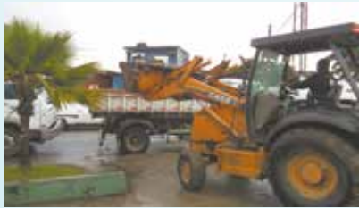
Demolição do piso para execução do playground e academia na Praça Guilherme Delius - Alemoa
