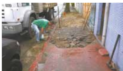
Recuperação da calçada danificada por raízes de árvores na Rua Bezerra de Menezes - Estuário
